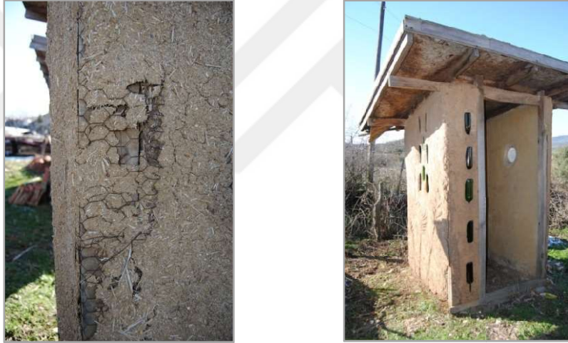
Şekil 4.15. Bayramiç/Yeniköy rabis telli bağdadi sıva (Bartu 2019-2020 arşivinden alınmıştır)
