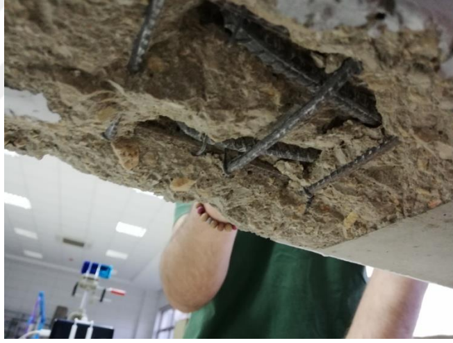
Şekil 4.26. Kirişin alt kısmında kabuk betonunun dökülmesi
