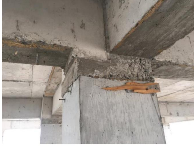
Şekil 1.1. Kolon-kiriş birleşin bölgesinde bırakılan soğuk derz (Ölmez 2019)
