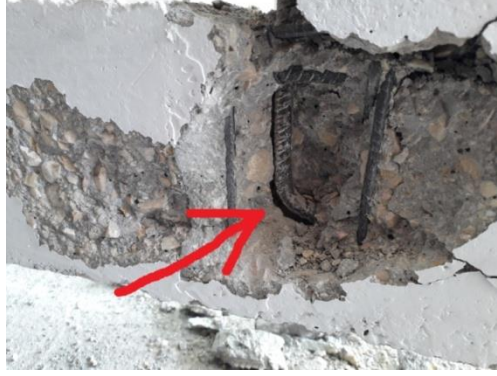
Şekil 4.24. Donatının betonu ezerek beton örtüsünü patlatıp betondan sıyrılması
