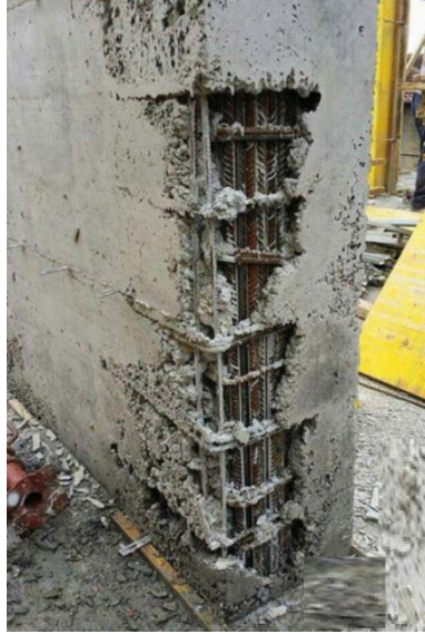
Şekil 1.6. Kolon-kiriş birleşim bölgesinde doğru vibratör uygulaması yapılmadığı için kalıba düzgün yerleşememiş beton, segregasyon (Anonim 2020)
