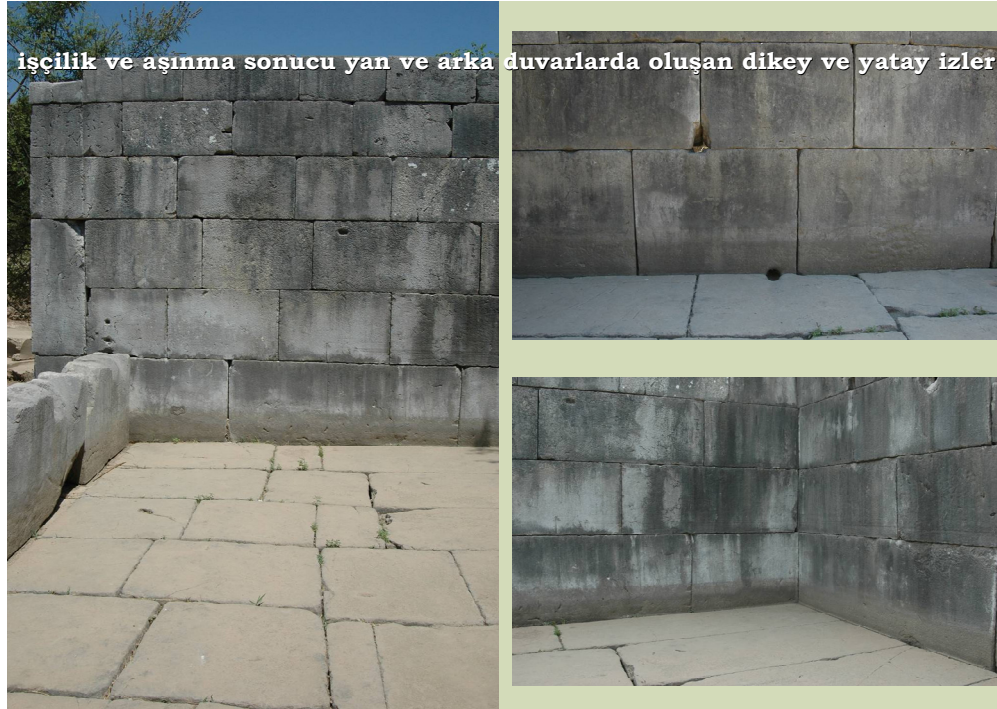
Şekil 6.3: İşçilik ve Aşınma Sonucu Yan ve Arka Duvarlarda Oluşan Dikey ve Yatay İzlerin Görünümleri
