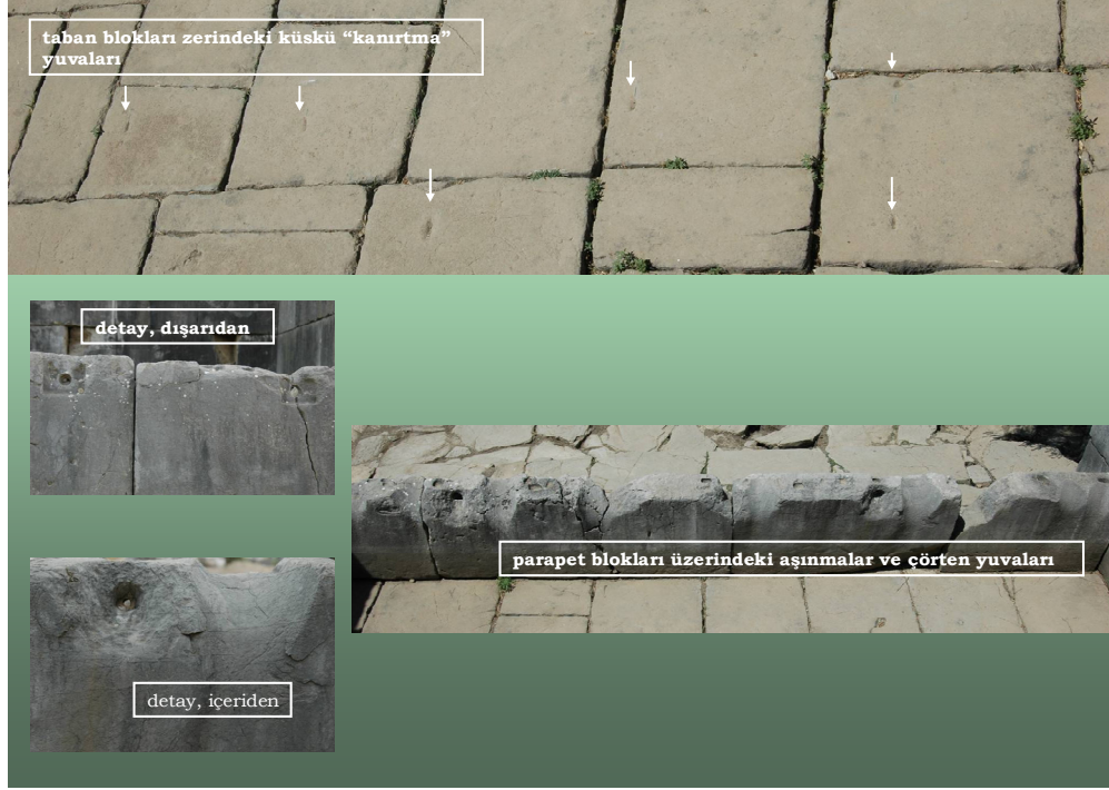
Şekil 6.2: Parapet Bloklarının Üzerindeki Aşınmalar ve Çörten Yuvalarının Görünümleri
