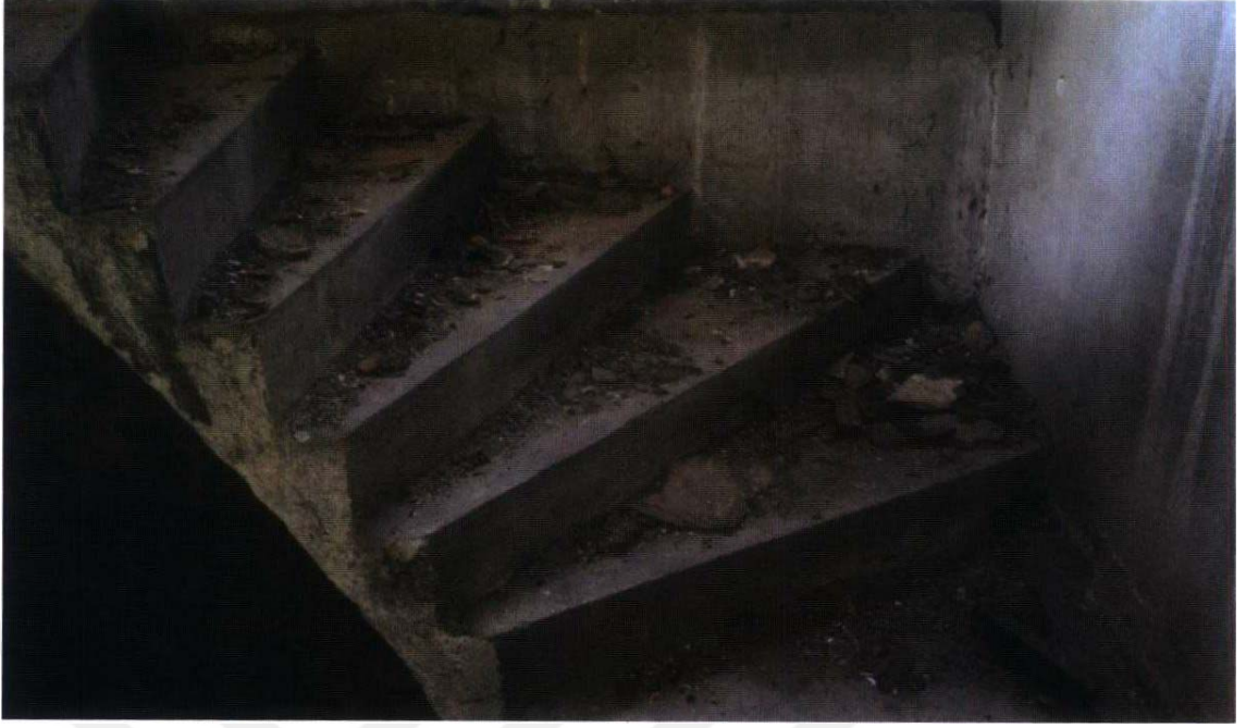
Şekil 17: Surp Asdvadzadzin Kilisesi'nin güneybatı köşesine sonradan eklenmiş merdiven.
