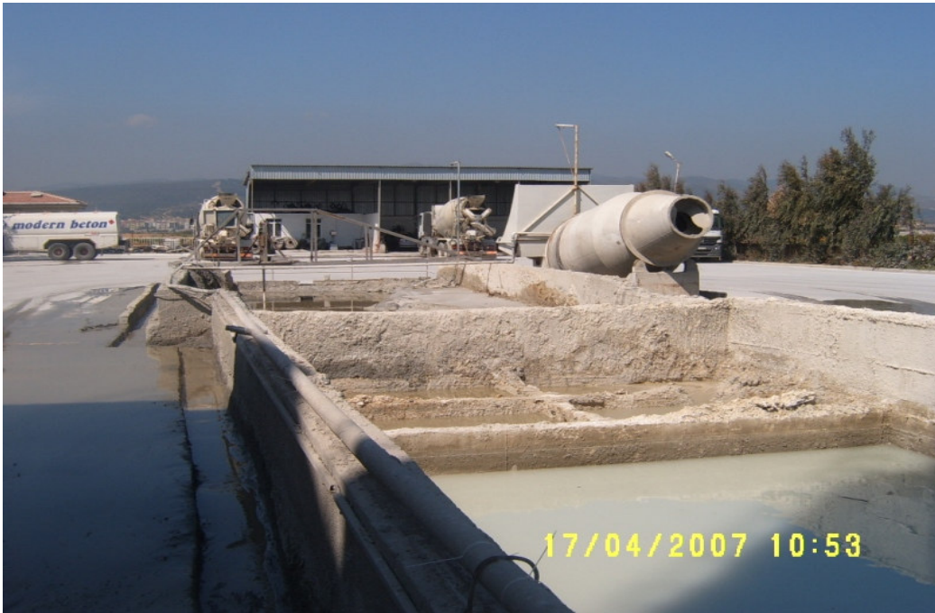
Resim 3.18 a- Geri Dönüşüm Havuzu
