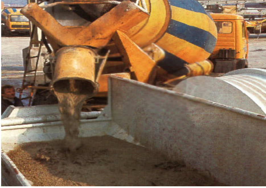
Resim 3.2 a- Beton Boşaltım Oluğu
