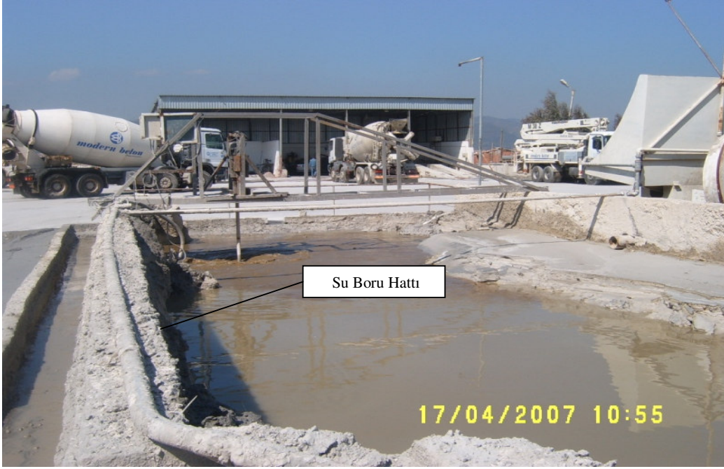
Resim 3.23 Su Boru Hattı 1
