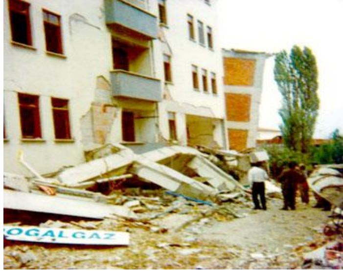
Şekil 2.12 Zemin katı dolgu duvarsız bir binanın deprem sonrası görüntüsü
