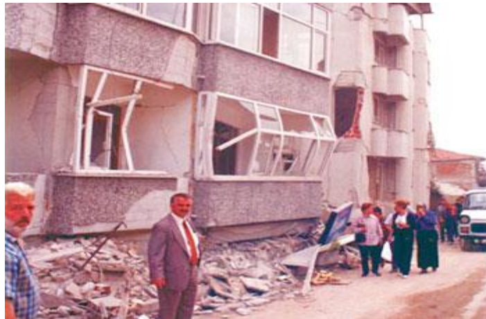
Şekil 2.11 Zemin katı dolgu duvarsız bir binanın deprem sonrası görüntüsü
