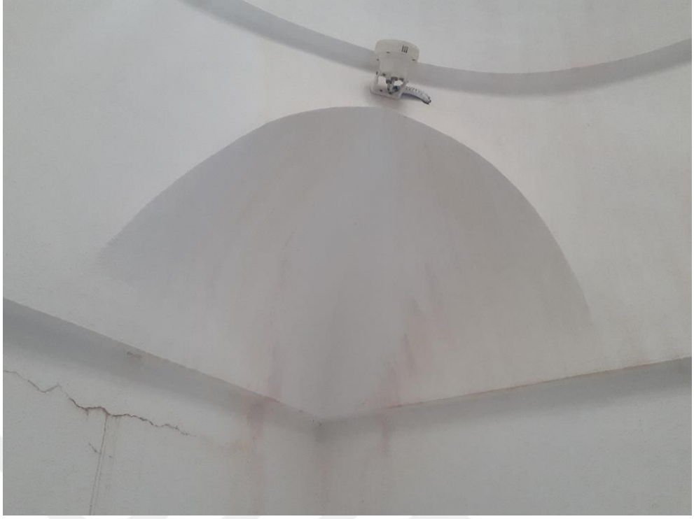
Fotoğraf 130: Baba Sultan Hamamı sıcaklık kubbe geiř trompu
