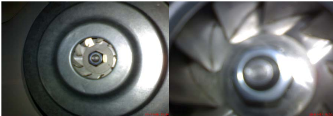
Figure D.6. Fan
