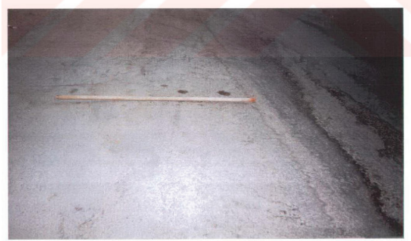
Resim 2.9 Kaplamada Kabarma Oluşumu.
