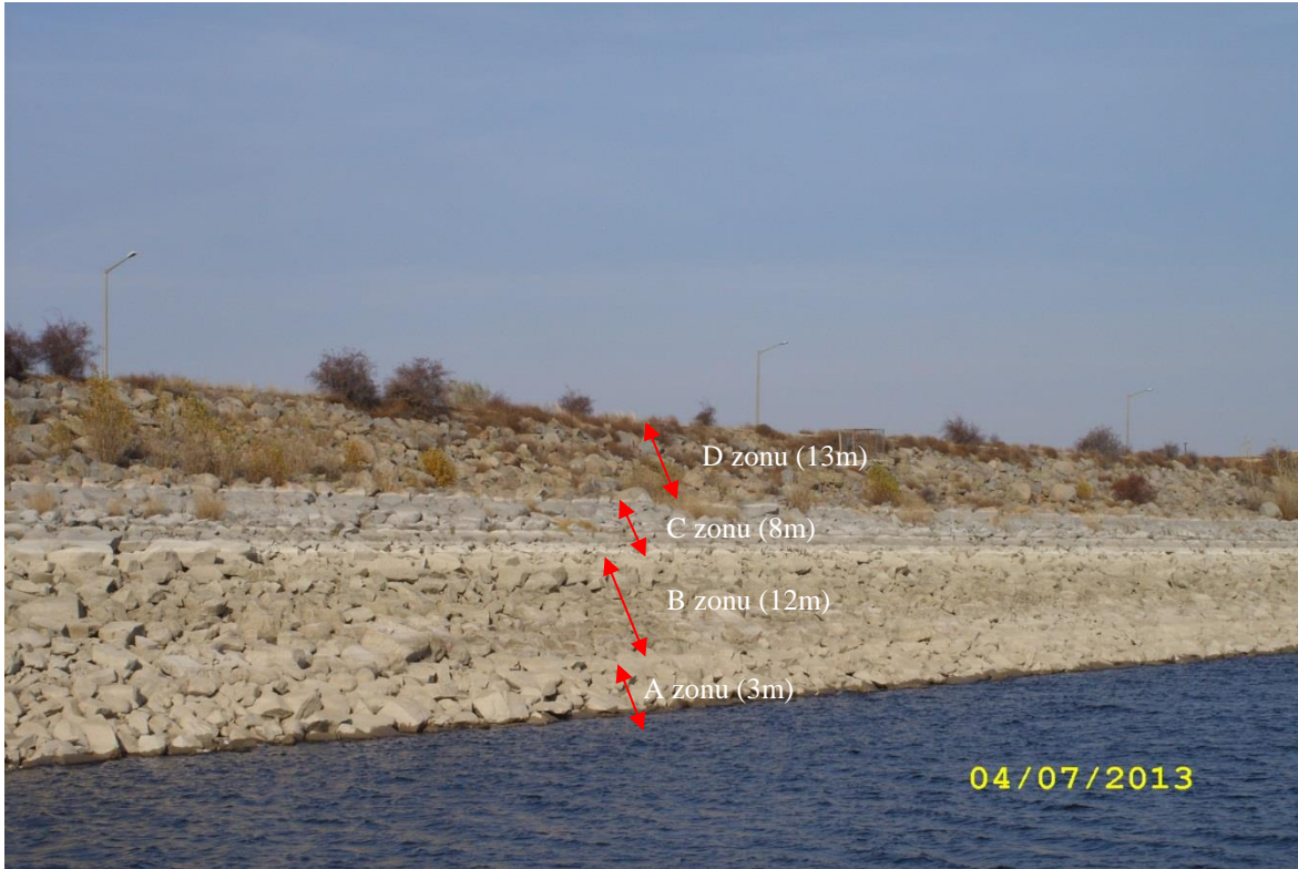
řekil 3.1. Baraj gövdesinin memba yüzeyinin genel görünümü ve riprap bloklarının suya maruz kalma sürelerine göre zonlara ayrılması.
