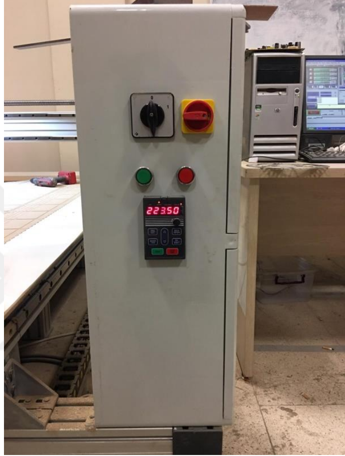
Şekil 4.67 Elektrik Panosu Dış Görünümü
