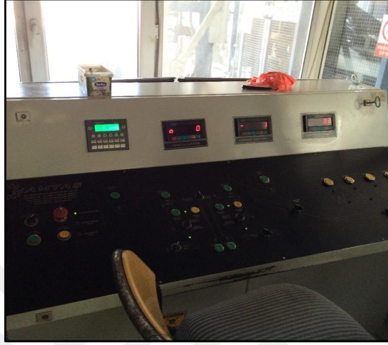
Şekil 3.15. Makina Kontrol Paneli
