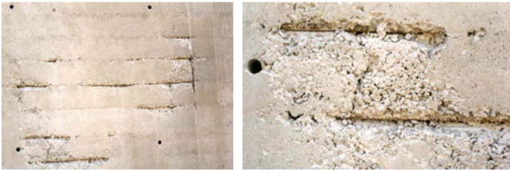
Resim 2.1 Sıkıştırma yetersizliğinden perdelerde olumsuz beton kalitesi
