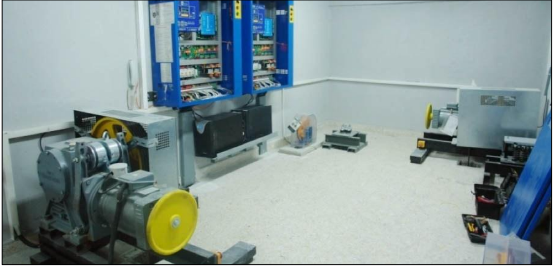
Şekil 3.3. Elektrikli asansör makine dairesi
