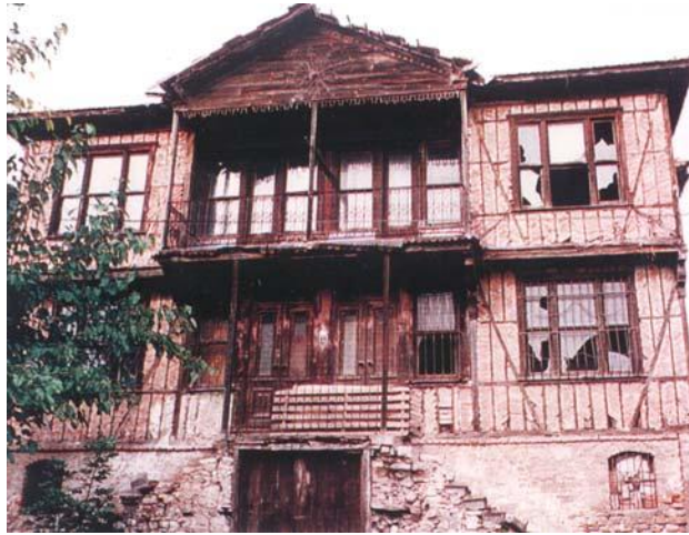
Resim 2.13 Zemin katı kâgir, üst katı ahşap iskeletli yapı örneği ( Aksoy ve Ahunbay 2005).
