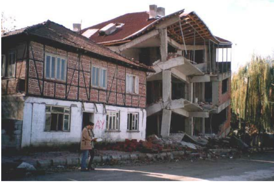
Resim 2.19 1999 Depreminden sonra geleneksel ve betonarme yapıların hasar görmüş durumları ( Dođangün vd. 2005).
