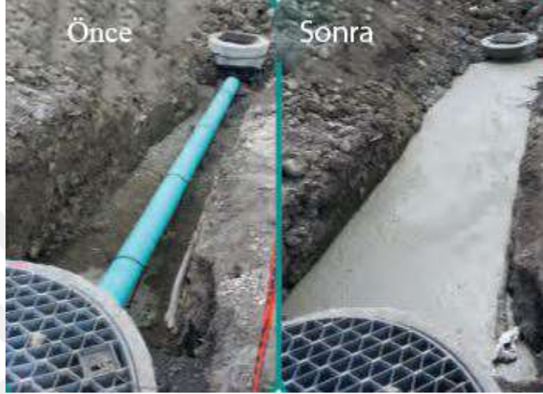
Şekil 2. 11 Köpük Beton İle Kapatılmış Kanalizasyon Borusu [85]
