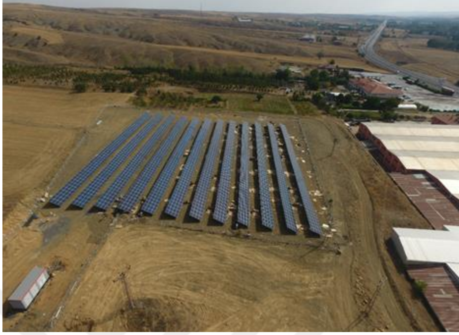
Şekil 5.2 Uygulama bölgesinde bulunan Güneş Enerjisi Santralinin üstten görünümü
