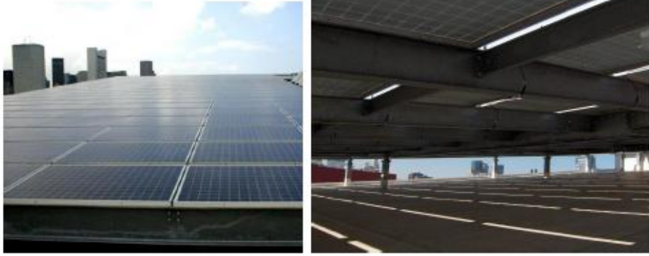
Şekil 2.15 Fotovoltaik sistemlerin düz çatılarda kullanımına ait bir örnek [25]
