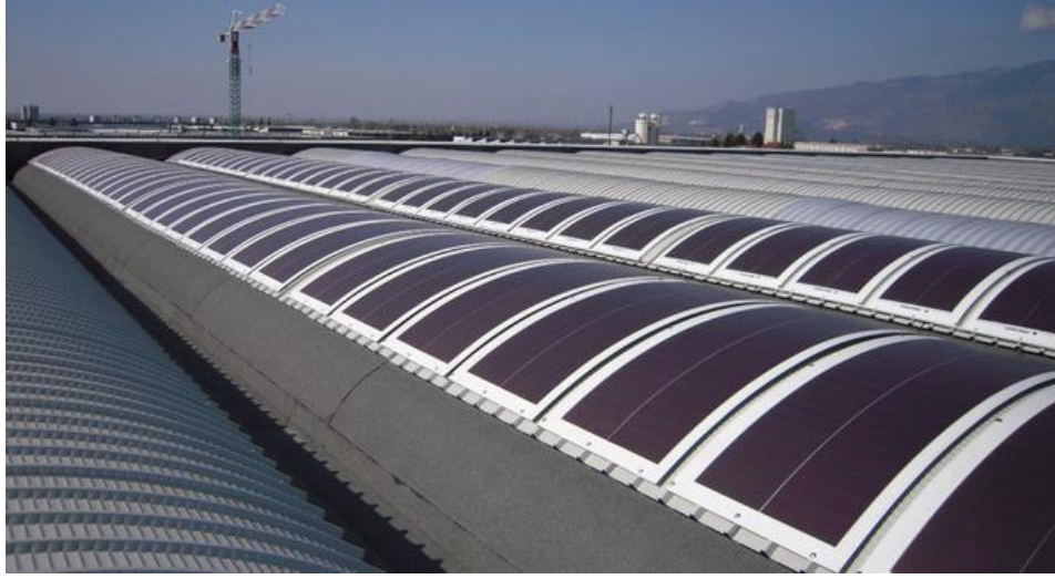
Şekil 2.20 Kavisli (eğrisel) çatılarda fotovoltaik sistemin kullanımına ait bir örnek[28]
