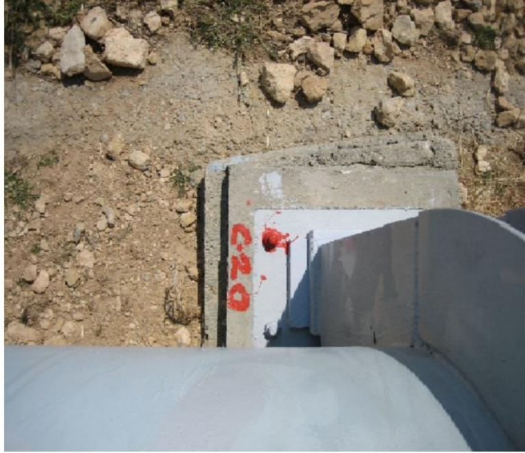
Resim 4.1 Cebri boruda bulunan ölçü noktası tesisi
