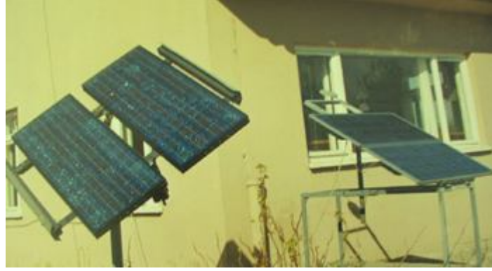
Resim 1.1 EİE'nin yerleştirdiği güneş takip sistemli PV paneller (İnt. Kyn. 3).
