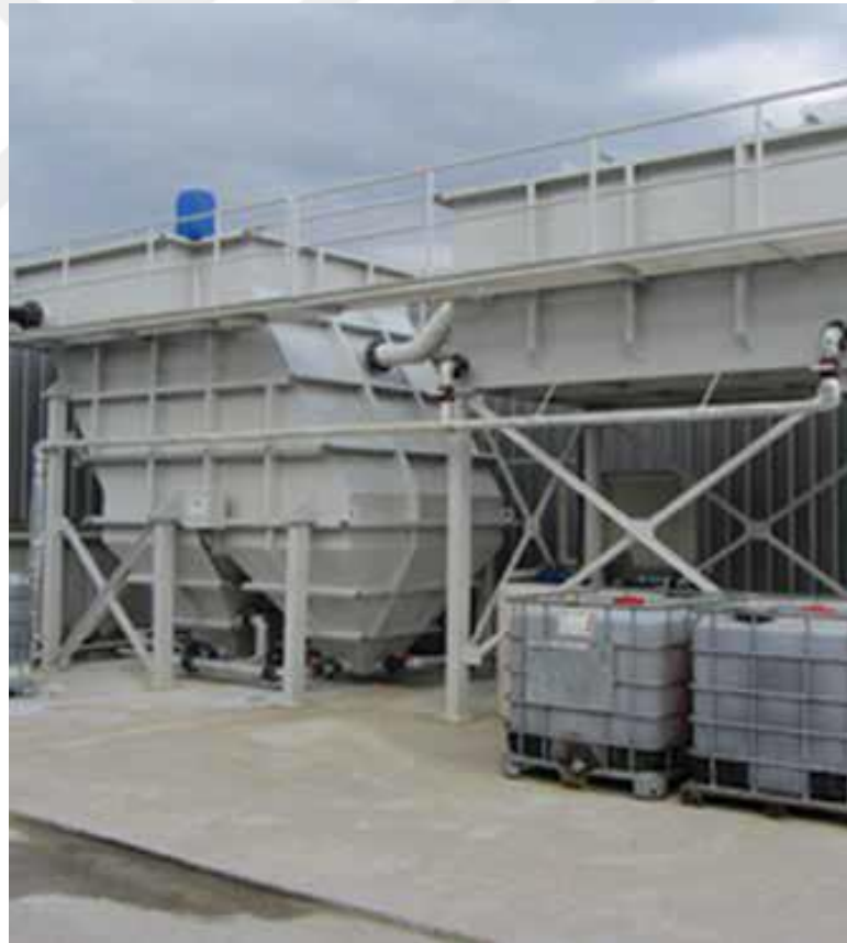
Şekil 6.9. Eloksal Kaplama Tesisi için Kimyasal Atıksu Arıtma Tesisi
