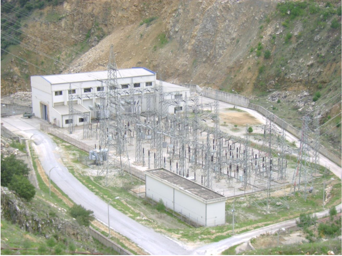
Resim 1.2. Adıgüzel Santral Binası ve Şalt Sahası
