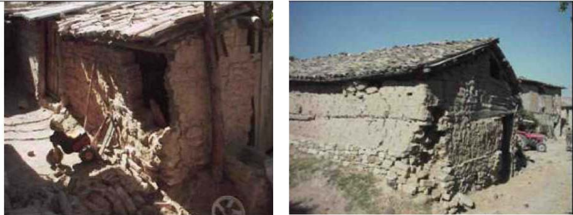
Şekil 3.35: Hasar gören hayvan barınakları
