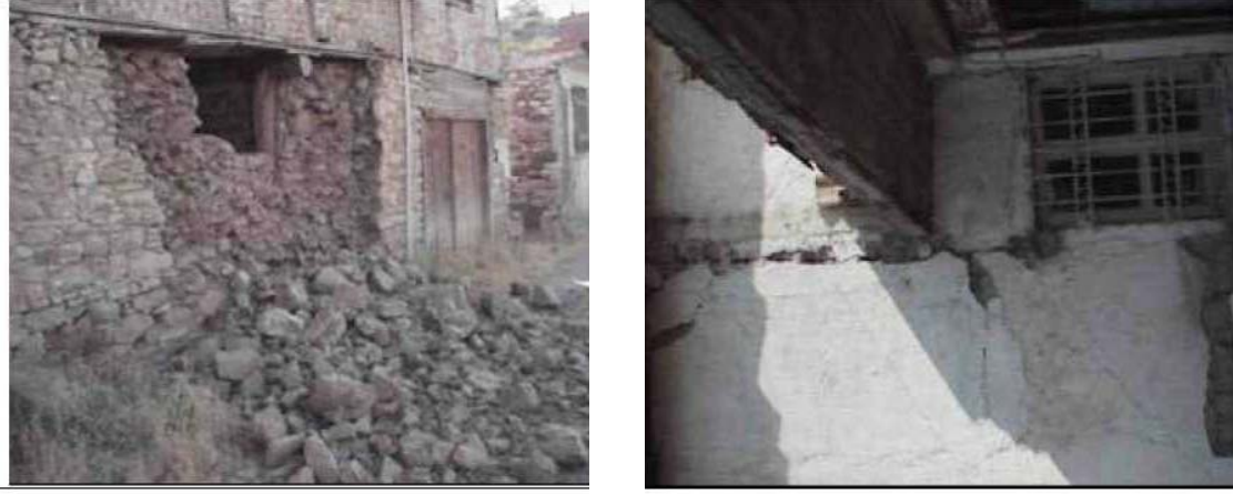
Şekil 3.36: Doğanköy'de yığma yapılarda oluşan hasarlar
