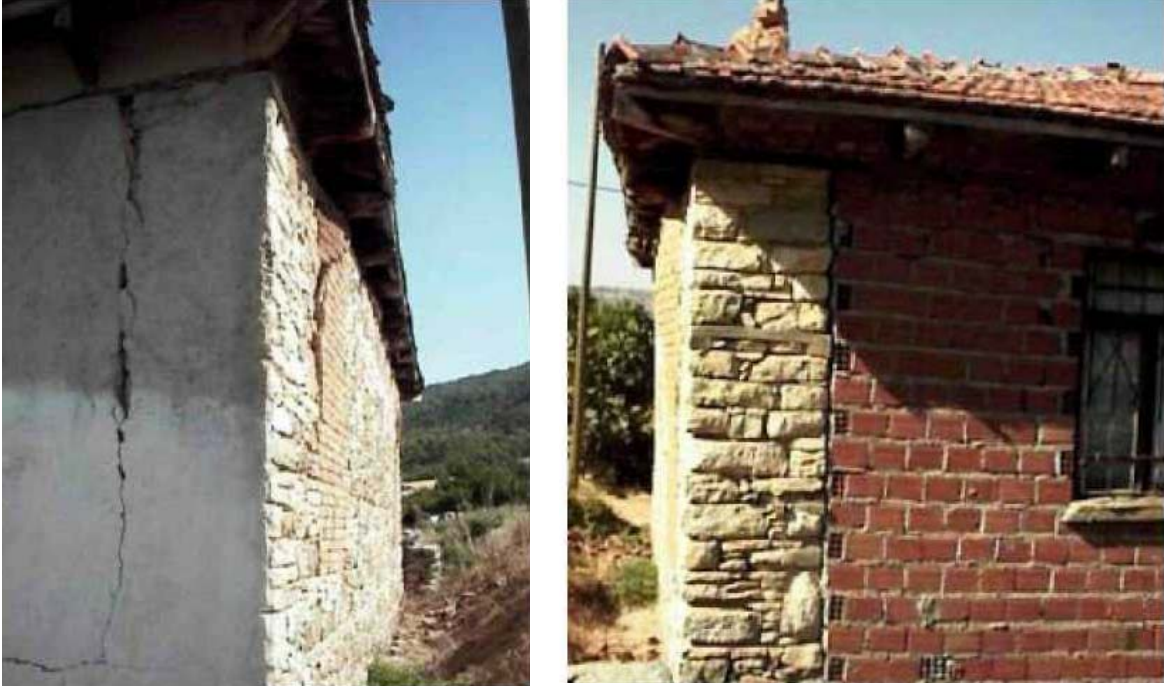
Şekil 3.29: Yatay ötelenmeden dolayı köşe noktalarda oluşan ayrışmalar
