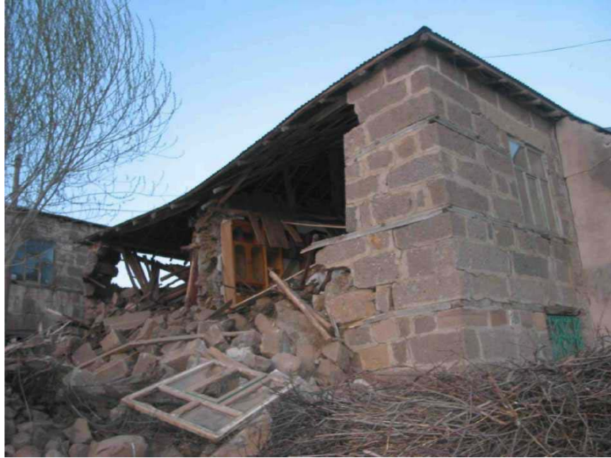
Şekil 3.2: Sadece görüntü esas alınarak yapılan duvar
