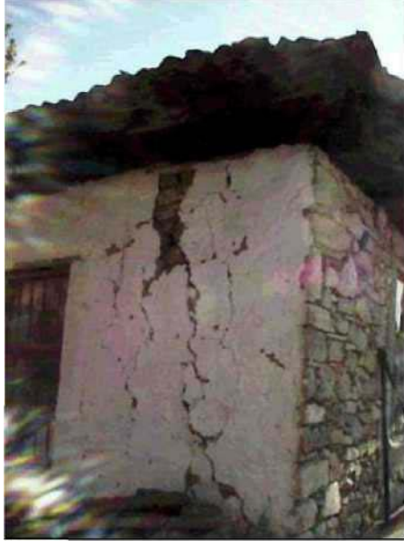
Şekil 3.39: Duvarda oluşan hasar.
