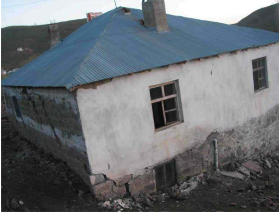
Şekil 3.14: Ağır Hasarlı Bir Ev
