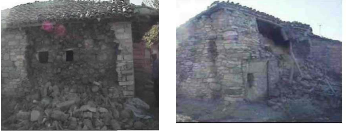
Şekil 3.38: Uygun kenetlenme olmadığı için yıkılan ve ayrılan duvarlar
