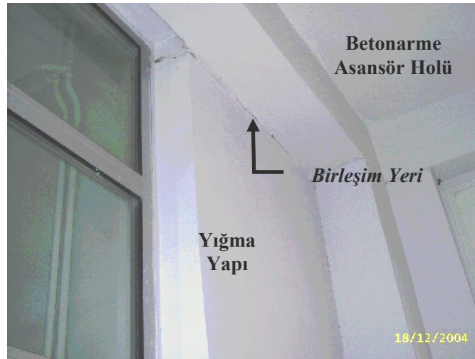
Şekil 4.14: Yığma yapı ile betonarme asansör holünün birleşim yeri
