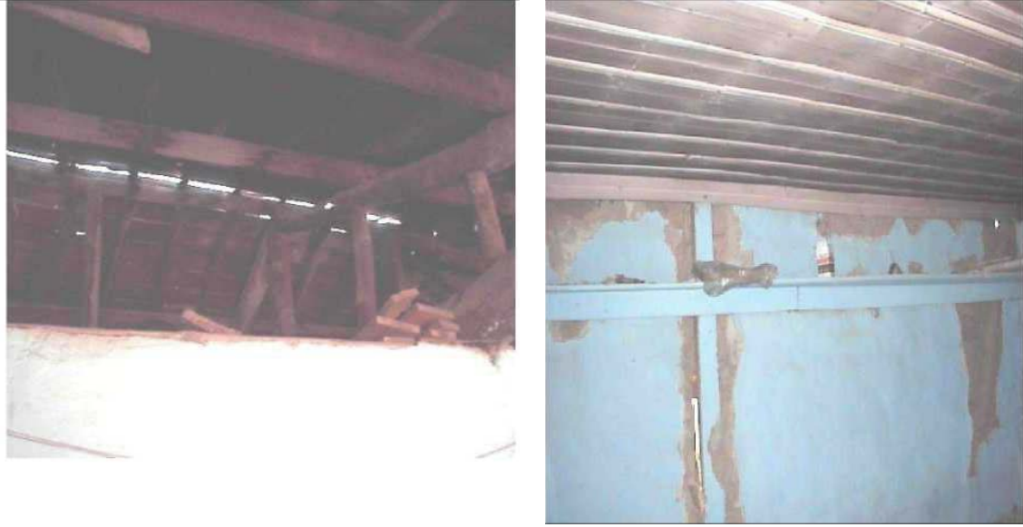
Şekil 3.32: Yığma yapıda, çatı arası ve bölme duvarlarda hasar.
