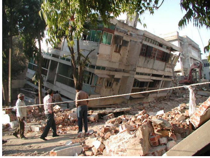
Şekil 2.4 : 2001 Hindistan Bhuj Depreminde ilk katı yumuşak kat nedeniyle göçmüş bir bina
