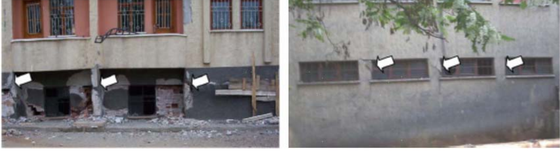
Şekil 2.8 : 2003 Bingöl depreminde kısa kolon nedeniyle hasar görmüş yapılar
