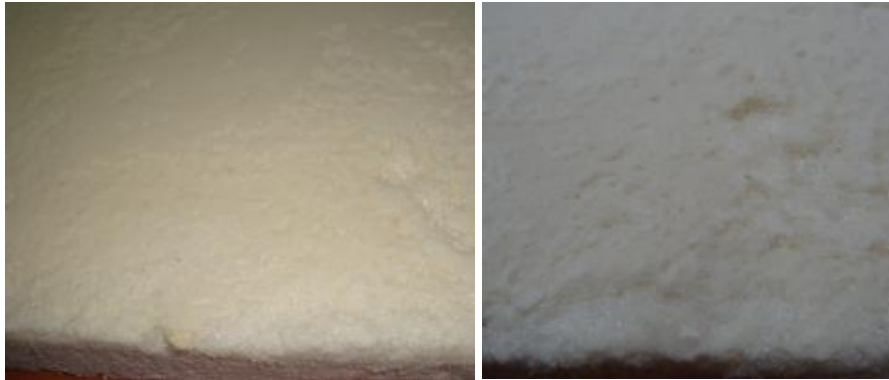
Şekil 3.6 : Bünyesinde su bulunduran katkı malzemesinin yapıyı ve yüzeyleri bozması
