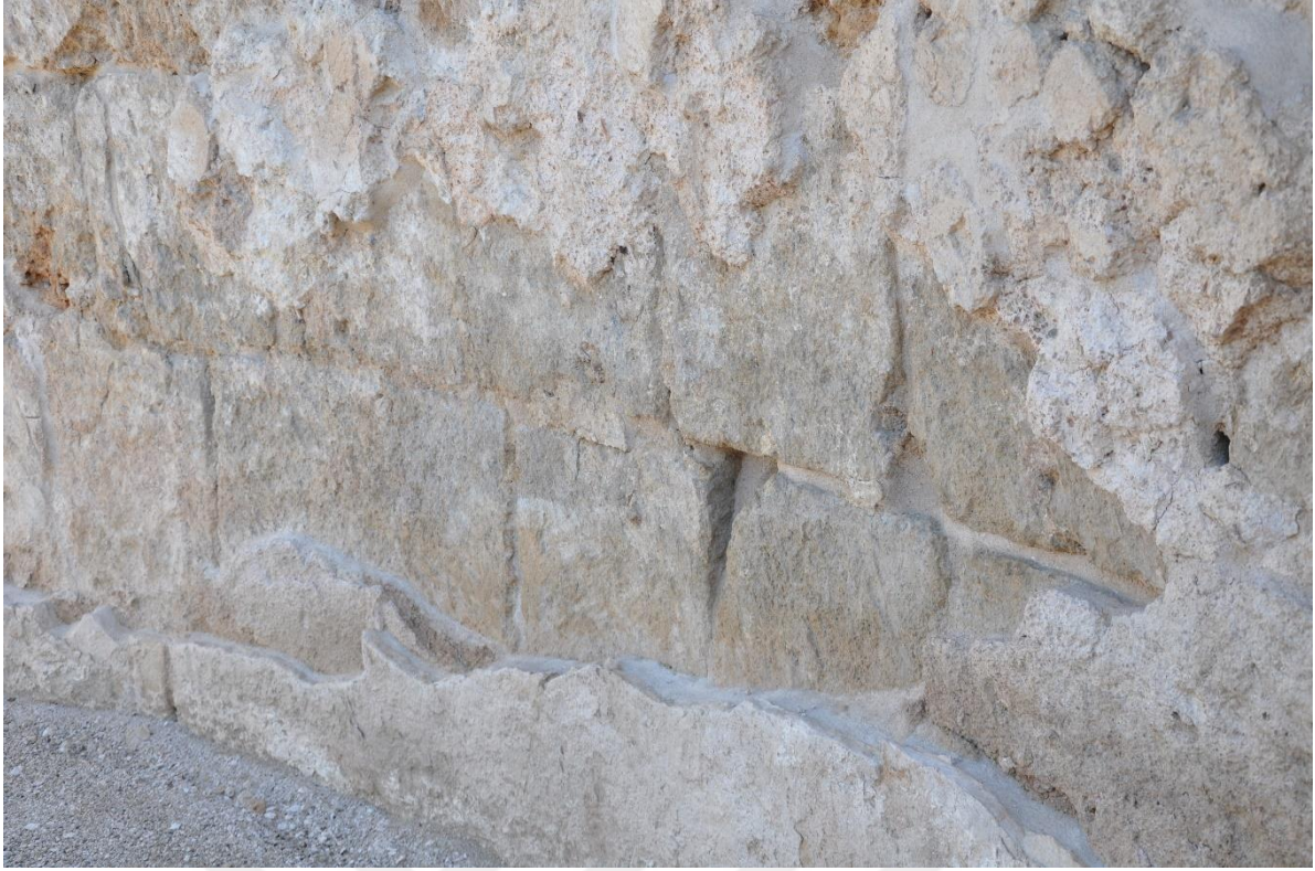
Resim 24: Mermer Kaplamaların Mevcut Durumu (E. Can)
