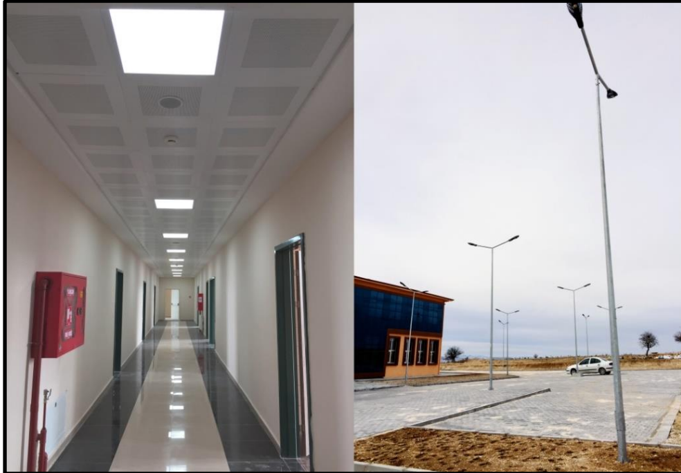
Şekil 6.8. MAKÜ Teknokent binası bina içi ve çevre led aydınlatma sistemleri (Özipek arşivi, 2017)
