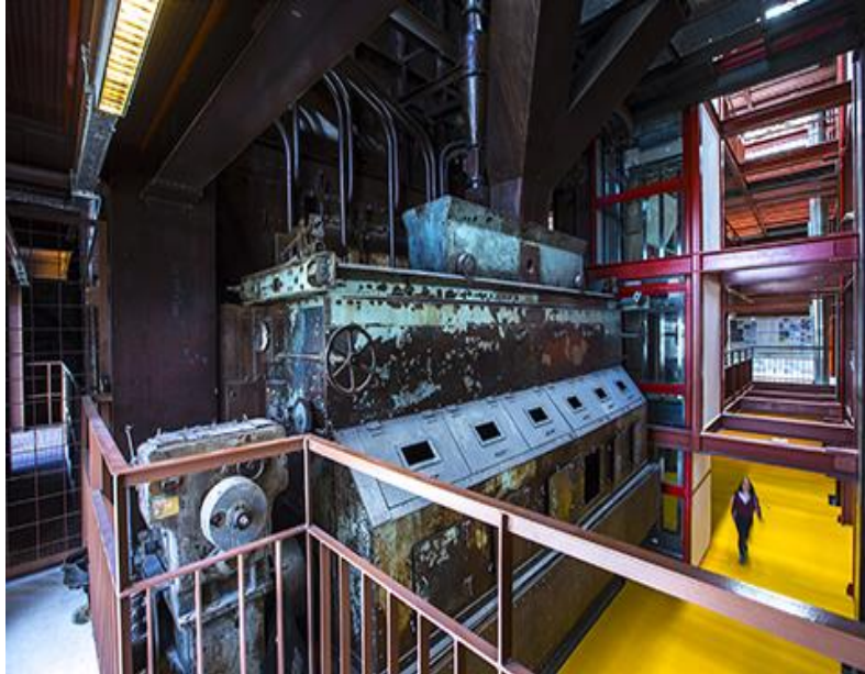
Şekil 5.5. Kazan dairesi binası (URL-28, 2019)
