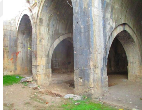
Şekil 3.43. İncir Han iç mekân bozulmaları (Bakır, 2017)
