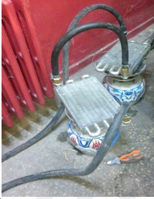
Şekil 3.48 Isıtma sisteminin görüntüsü.
