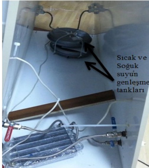
Şekil 3.49 Sistemdeki genleşme tanklarının görüntüsü.
