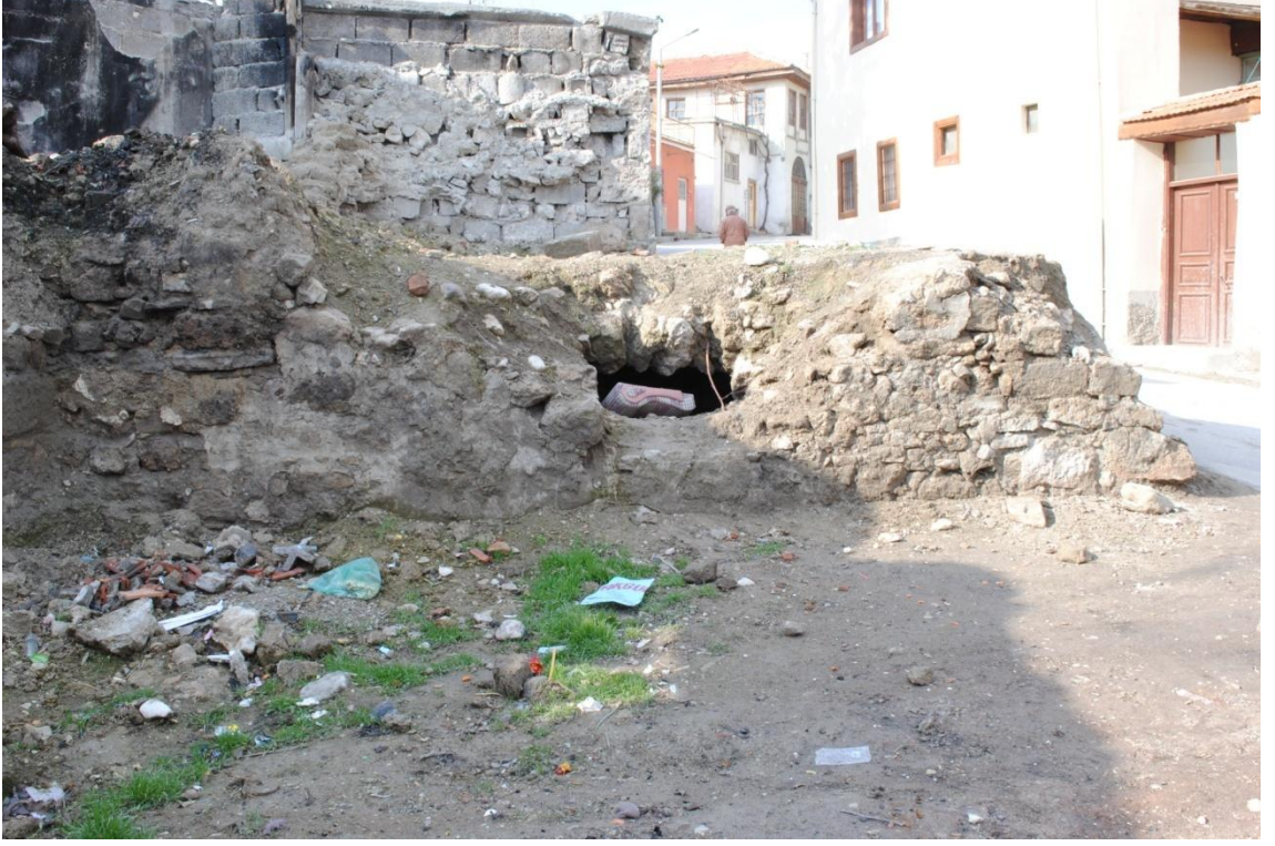
Fot.18: Eskiyesi Camii eşmesi Yıkılan Tonoz
