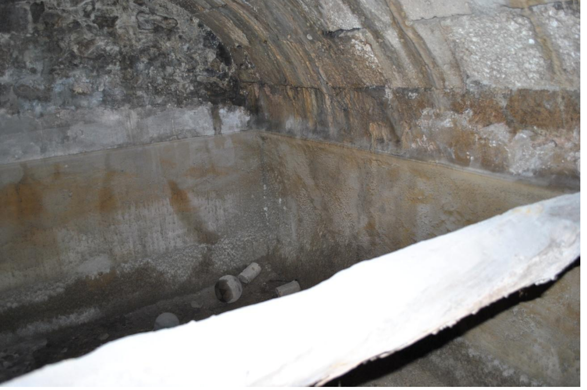
Fot. 52: Mısırlılar Evi eşmesi 2 Depo Bölümündeki Ahşap Hatıl
