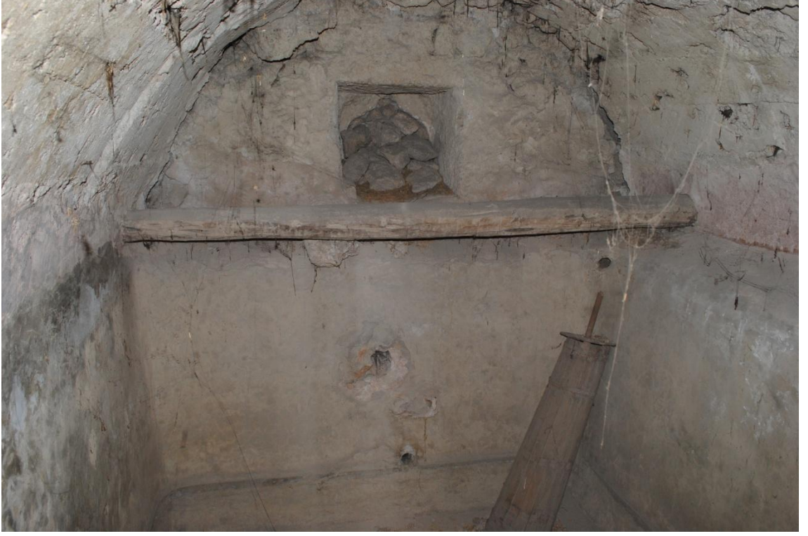
Fot.14: Depo Bölümü Devecilerin Çeşmesi Depo Bölümü ve Ahşap Hatıl
