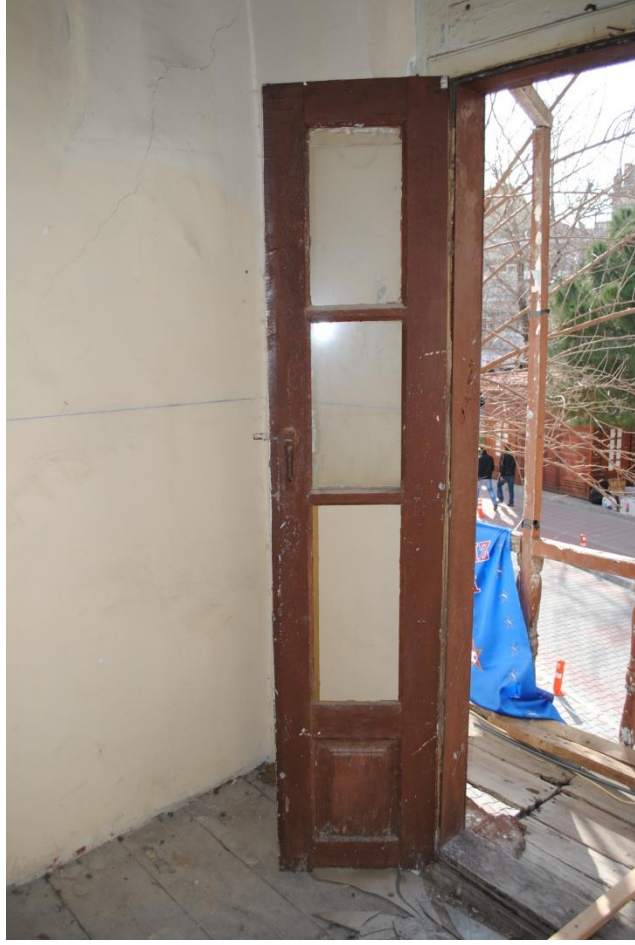
Foto. 31: Balcıođlu Hanı Üst Katta Kuzey Cephedeki Balkon Kısımına Açılan Kapı Kanadı
