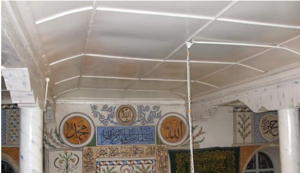
Resim 402: Denizli, Çivril Bulgurlar Köyü Cami, 18.Yüzyılın Üçüncü Çeyreği-19.Yüzyılın Sonları, Orta Sahnın Görünümü, Detay.
