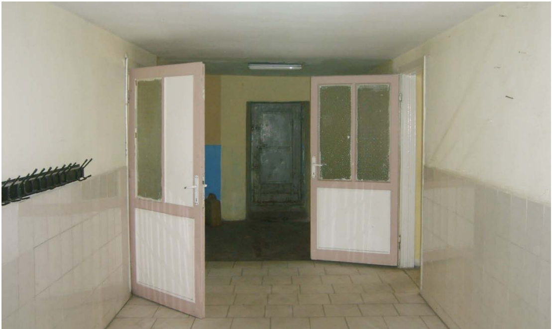
Fot. 276: Bodrum Kat Koridorun Batı Cephesindeki Kapı Açıklığı (Onarım Öncesi).
