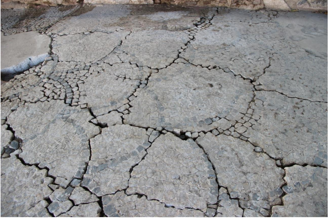
Figür 20: 2 Nolu Panel Çatlama Örneği
