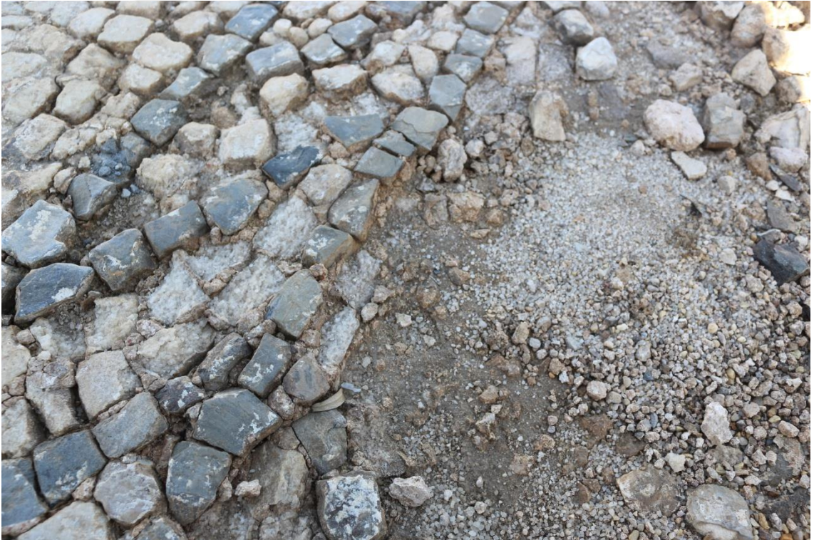
Figür 27: 5 Nolu Panel Tessera Bozulması (Ufalanma) Örneđi
