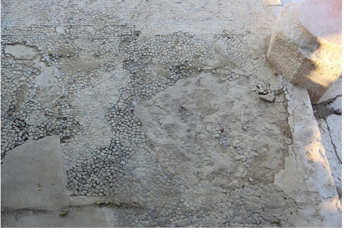
Figür 31: 3 Nolu Panel Derz ve Lakuna Bozulma Örneği
