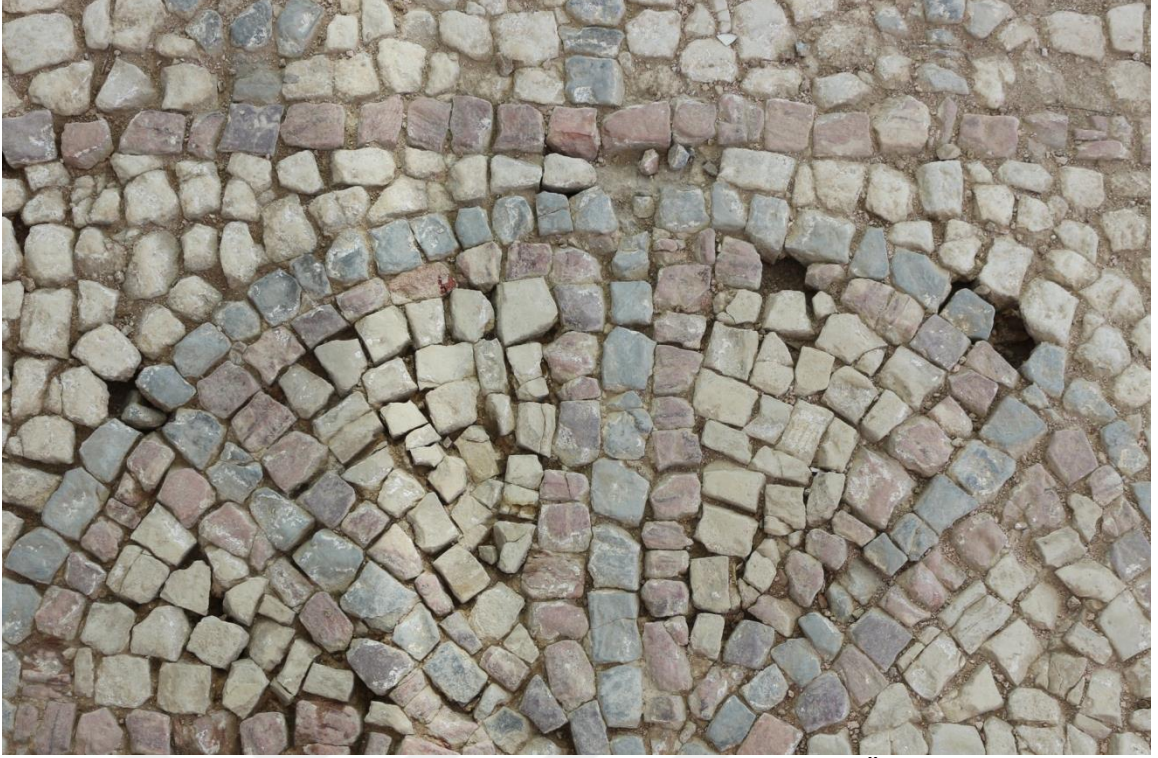
Figür 26: 5 Nolu Panel Tessera Bozulması (Kırılma) Örneđi
