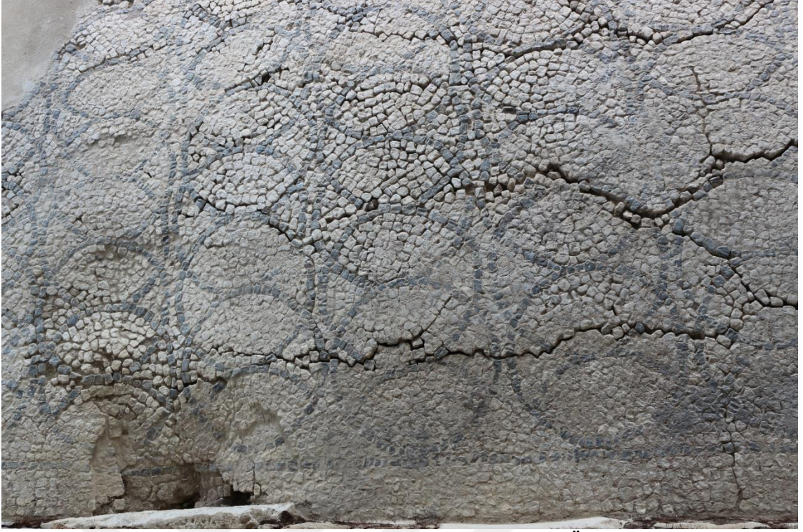
Figür 22: 3 Nolu Panel Çökme ve Yükselme Örneği
