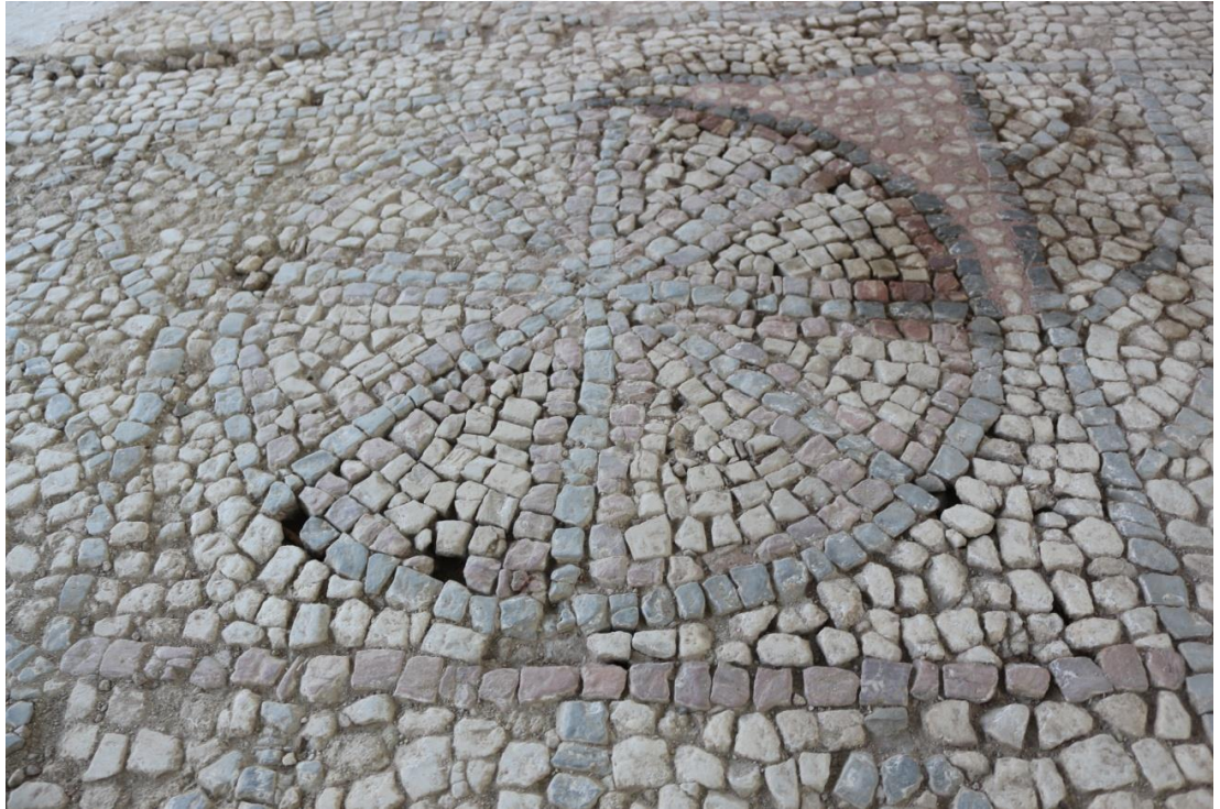
Figür 25: 5 Nolu Panel Derz Bozulması Örneği
