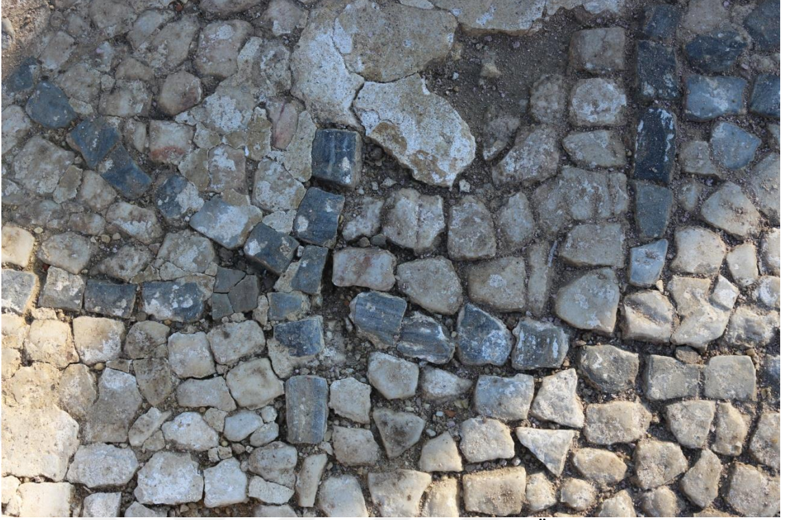
Figür 32: 5 Nolu Panel Derz Bozulması Örneđi
