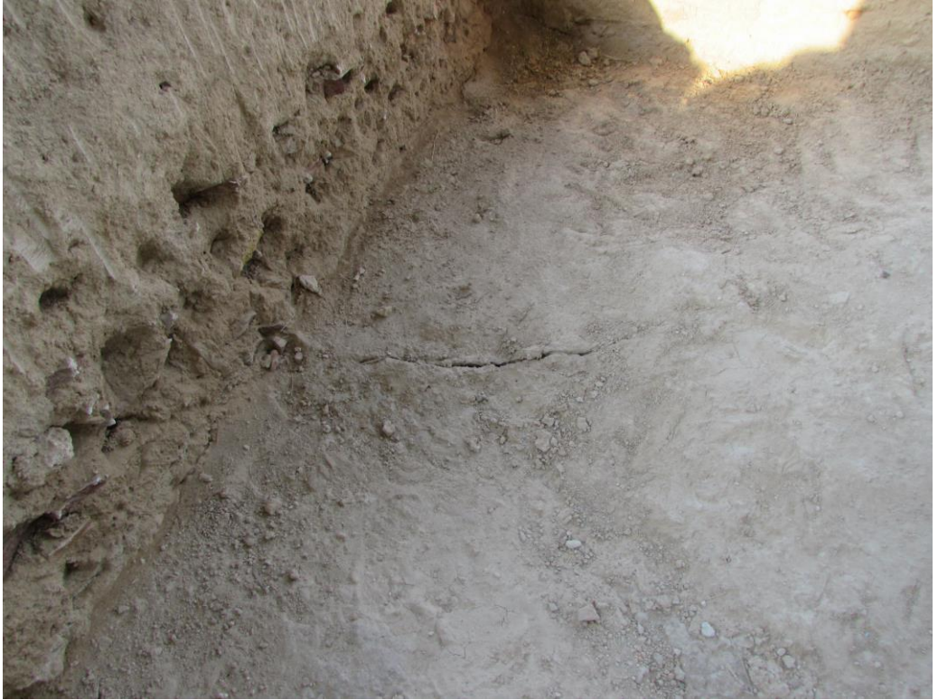
Fig. 133: Hamam Görevlilerine Ait B Bölümünde Tespit Edilen Fay Çatlağı
