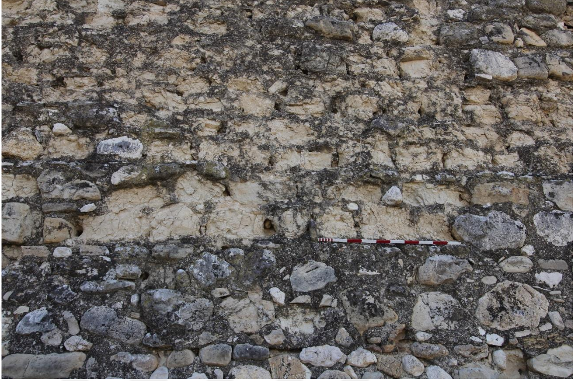
Fig.44e: Geç Bizans Batı Surunun Batı Cephesi'nde Yer Alan Dökülmeler ve İskele Delikleri.
