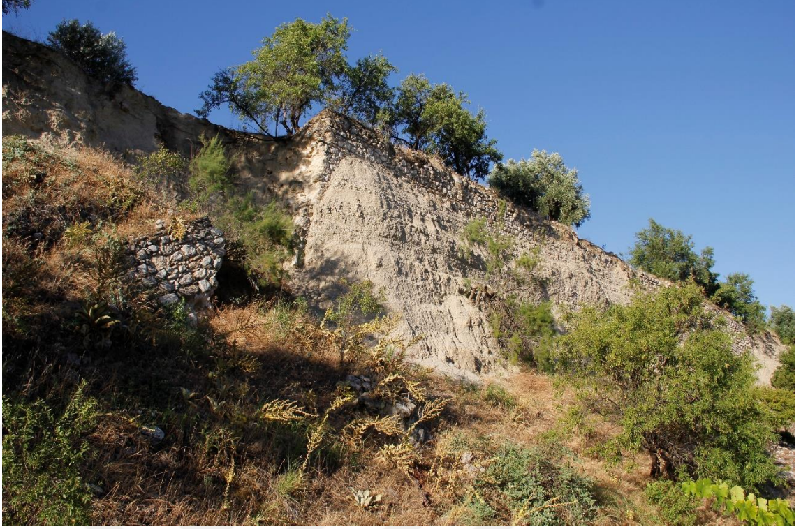
Fig.71c: Hacı Osman Zeytinliđi Mevkisi evre Surunun Yıkılmıř Bölümü.
