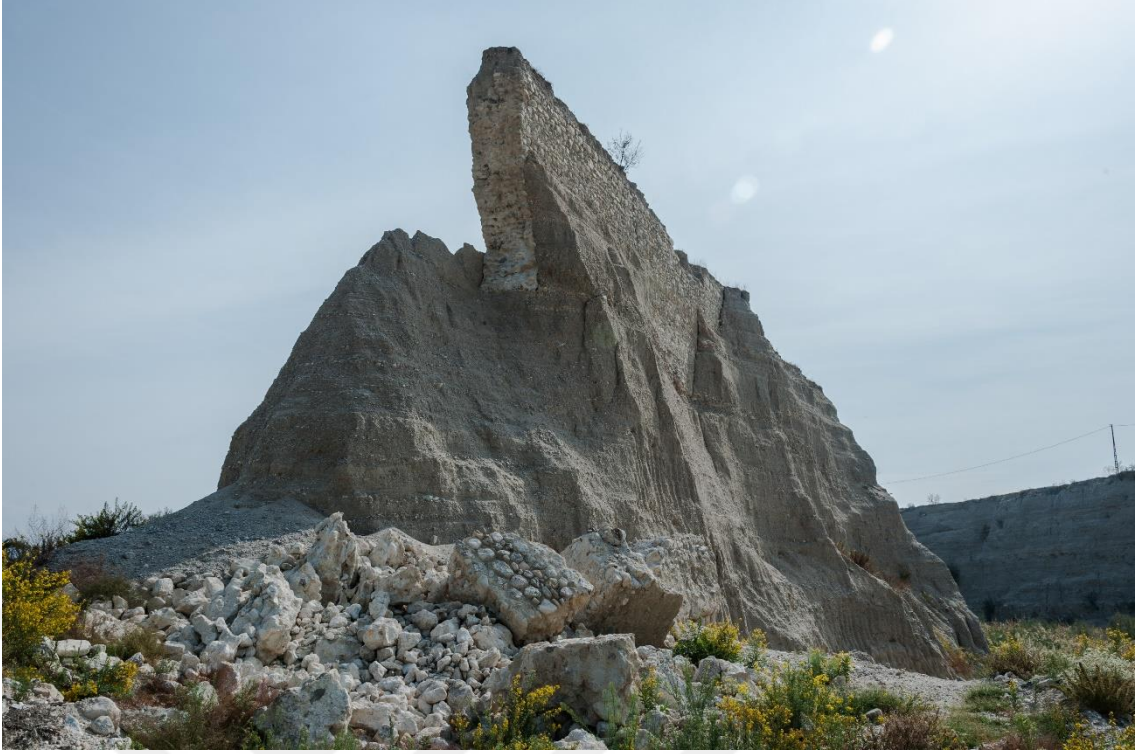
Fig.77e: Çayınkaşı Mevkisi Çevre Surunun Kuzey Kesiti ve Yıkılarak Düşen Sur Parçaları.
