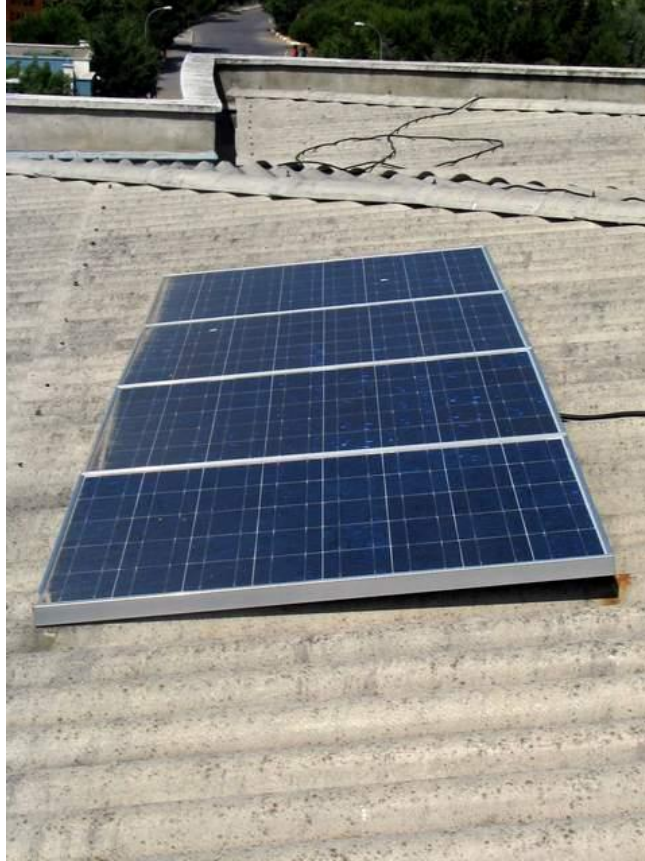
Şekil V-1 Fotovoltaik Panellerin Görünümü.
