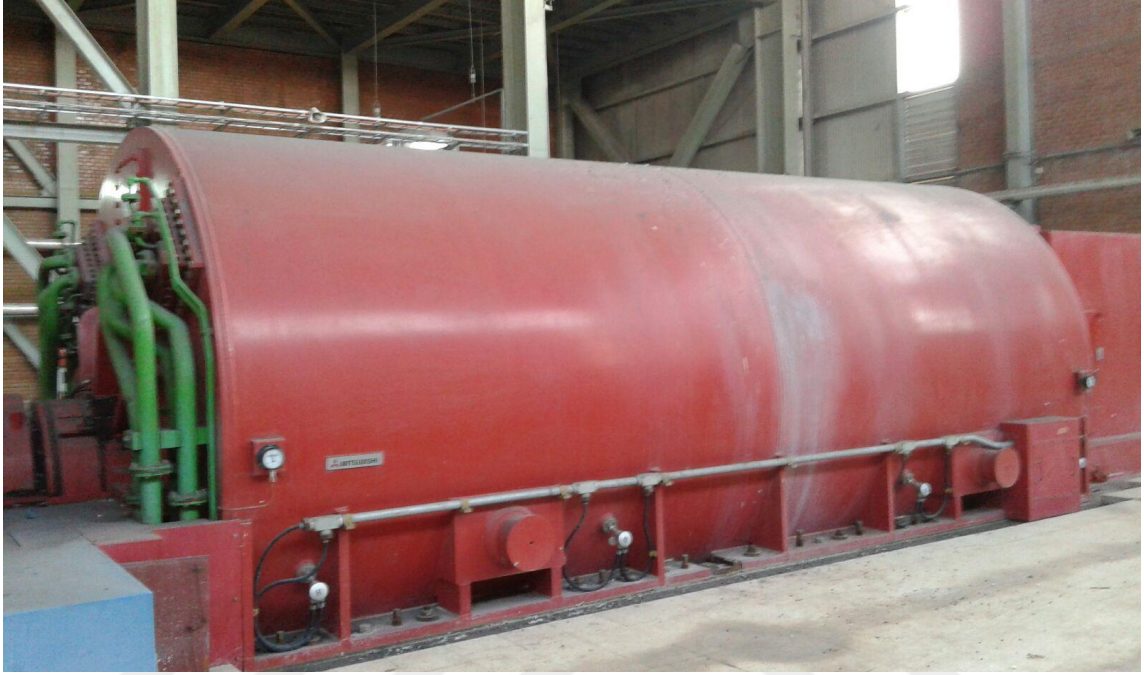
Şekil 2.5 Generatör Sistemi (Yüce, 2018).
