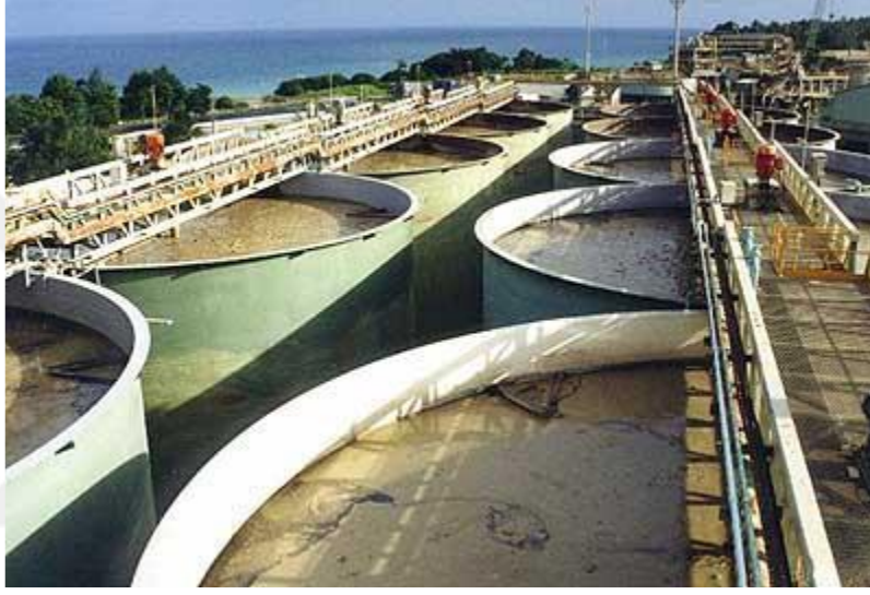
Şekil 9. Endüstriyel tesislerde kullanılan tank liçleri [28].
