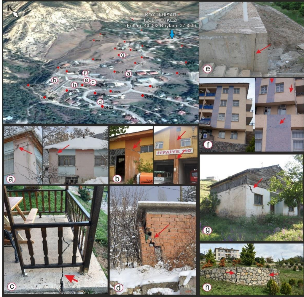
Şekil 3.30 Binalarda meydana gelen deformasyonlar (Hastaoglu vd., 2015).
