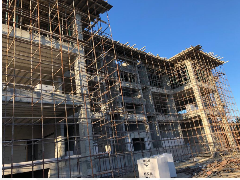
Şekil 3.25 Dışcephe ve Güvensiz İskele
