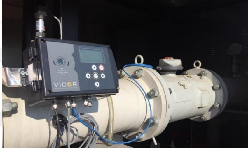
Şekil 2.19 Doğal gaz Ölçümü Yapılan Türbinmetre Sayaç ve Elektronik Gaz Hacim Düzeltici (VHS Elektronik VİCOR)
