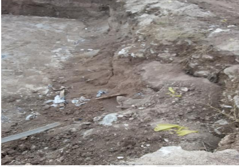
Şekil 4.17 Temel Kazısı Sonrasında Toprak Göçmesi
