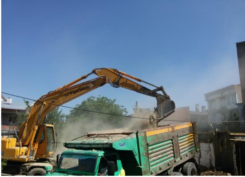
Şekil 4.21 İş Makinesinin Elektrik, Doğalgaz, Su, Kanalizasyon Hattı Çevresinde Kontrolsüz Çalışması
