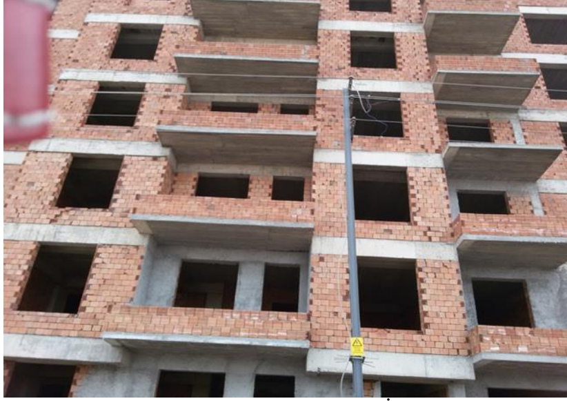
Şekil 4.35 Elektrik Hattına Yakın İnşaat Alanı
