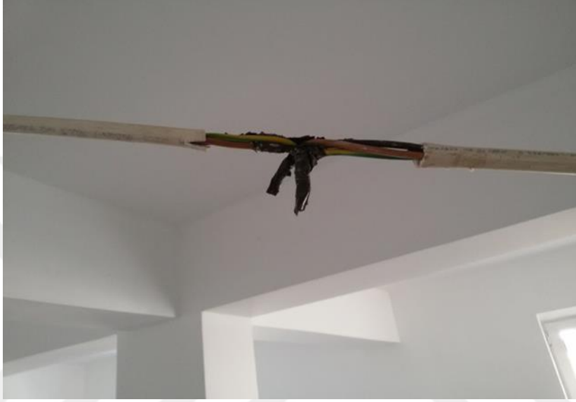
Şekil 4.32 Elektrik Kablosunun Ek Yerinin Açıkta Kalması
