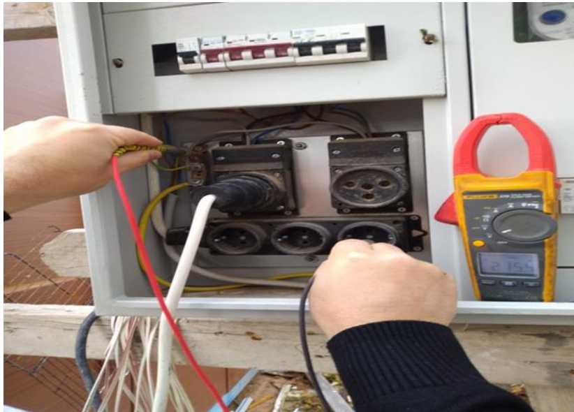
Şekil 4.41 Şantiye Panosunda Faz-Toprak Arası Gerilim Kontrolü
