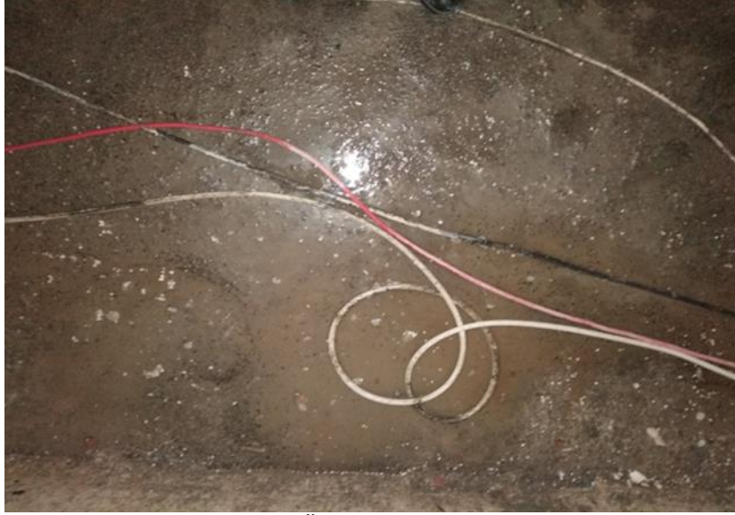
Şekil 4.33 Islak Zemin Üzerinden Geçen Elektrik Kabloları
