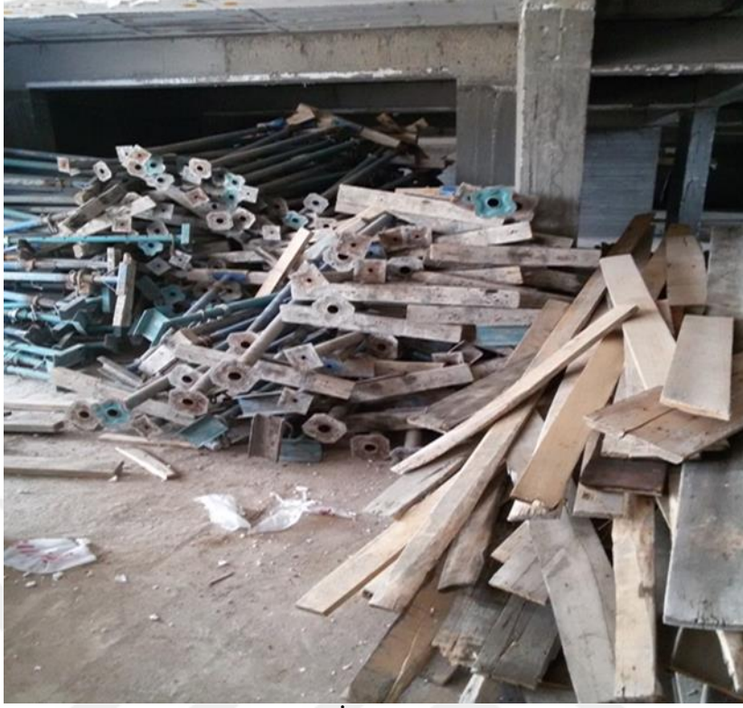
Şekil 4.9 Yanlış İstiflenmiş Malzemeler
