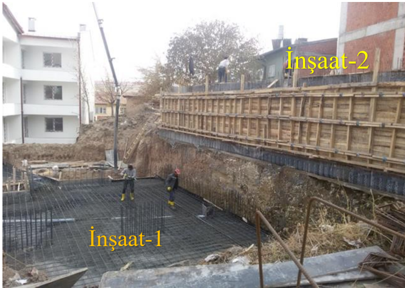
Şekil 4.19 Bina İnşaat Temelinin Kayma Riski
