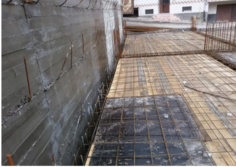
Şekil 4.15 Beton Kalıbındaki Dışarı Taşmış Demirler
