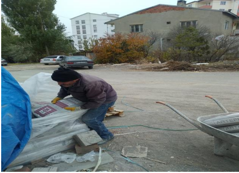
Şekil 4.49 Malzemelerin Dengesiz Kaldırılması ve Taşınması
