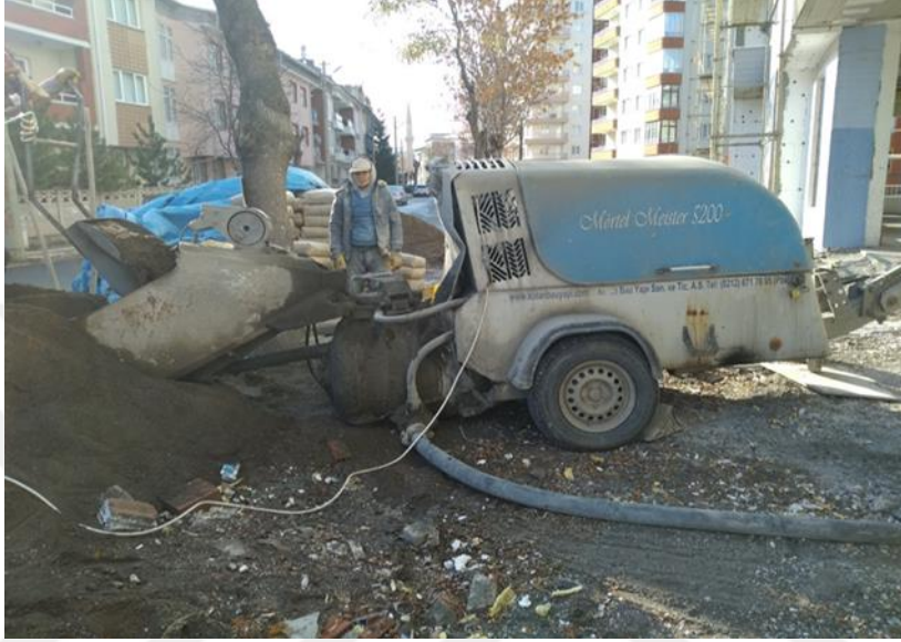
Şekil 4.29 Elektrikle Çalışan İş Makinesinde Gövde Topraklamasının Yapılmamış Olması
