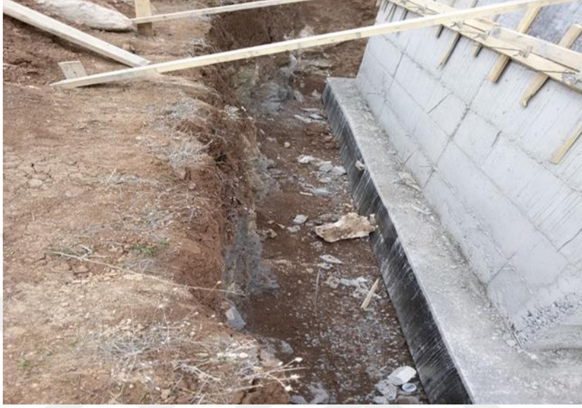
Şekil 4.5 Kazı Çukuru ve Bina Kenarındaki Boşluk
