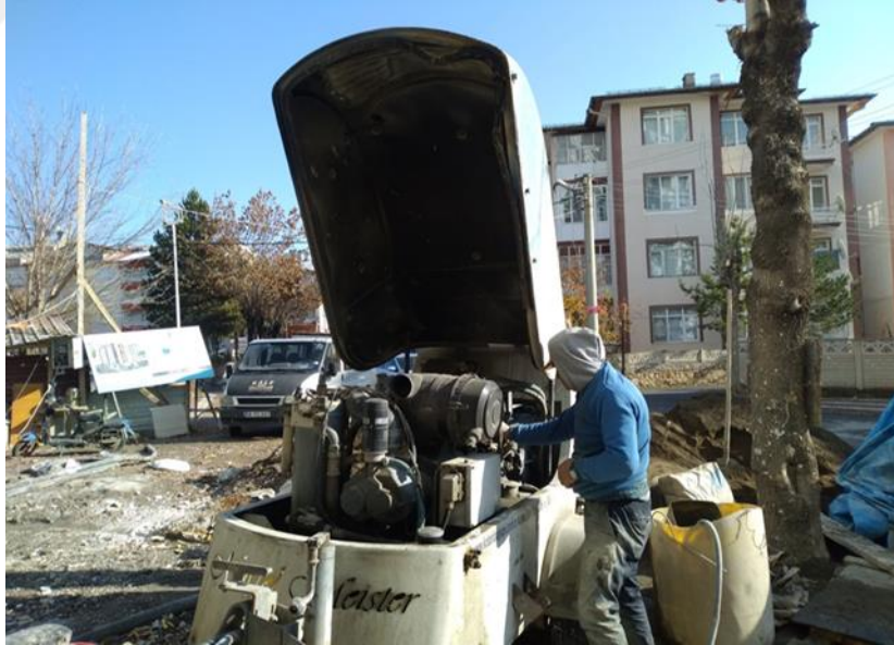
Şekil 4.16 Şantiyedeki Makinelerin Yetkisiz Kişiler Tarafından Bakım ve Onarımının Yapılması
