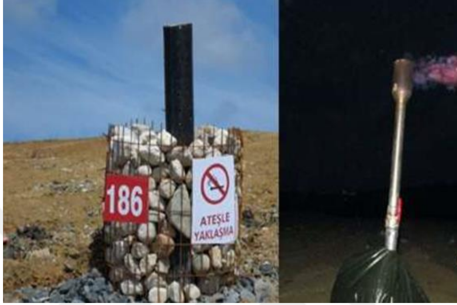
Şekil 4.20 Pasif gaz toplama örneği, gaz meşalesi (Çevre ve Şehircilik Bakanlığı, 2015).
