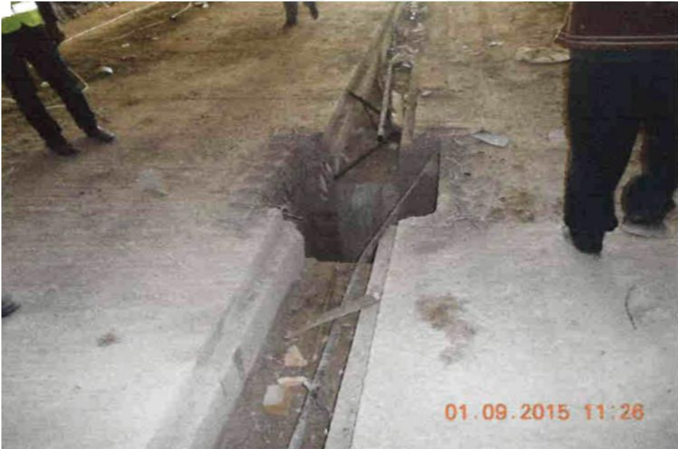
Şekil 5.28 İnşaat sahasındaki boşluklar
