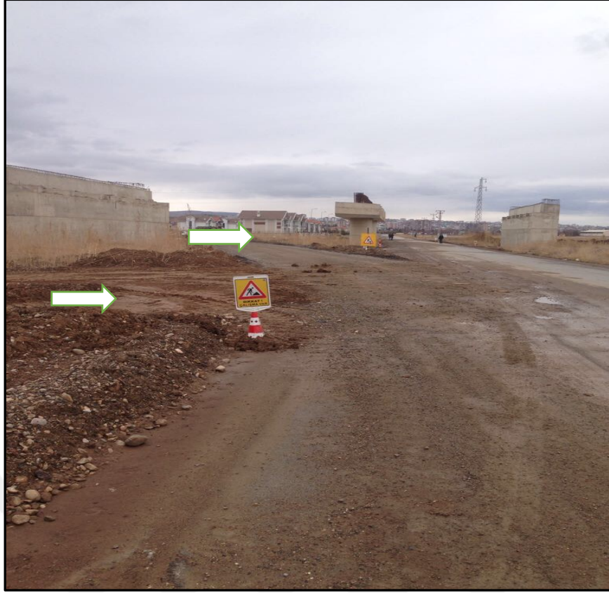
Şekil 5.41 Açılan servis yoluna yerleştirilen sarı zemin üzerine siyah piktogramlı uyarı levhaları
