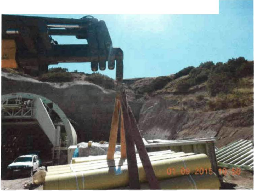
Şekil 5.27 Emniyet mekanizması çıkmış vinç
