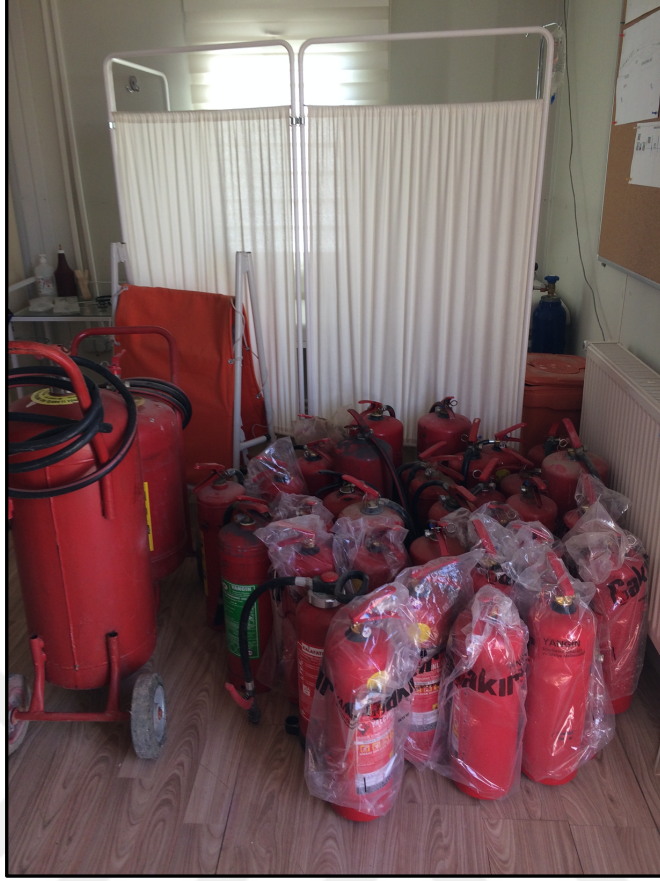
Şekil 5.2 Kamp alanına yerleştirilecek olan kontrol ve deneyleri yapılmış yangın söndürücü tüpler
