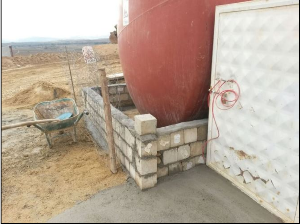
Şekil 5.5 Mazot tankı taşıma havuzu ve topraklama bağlantısı
