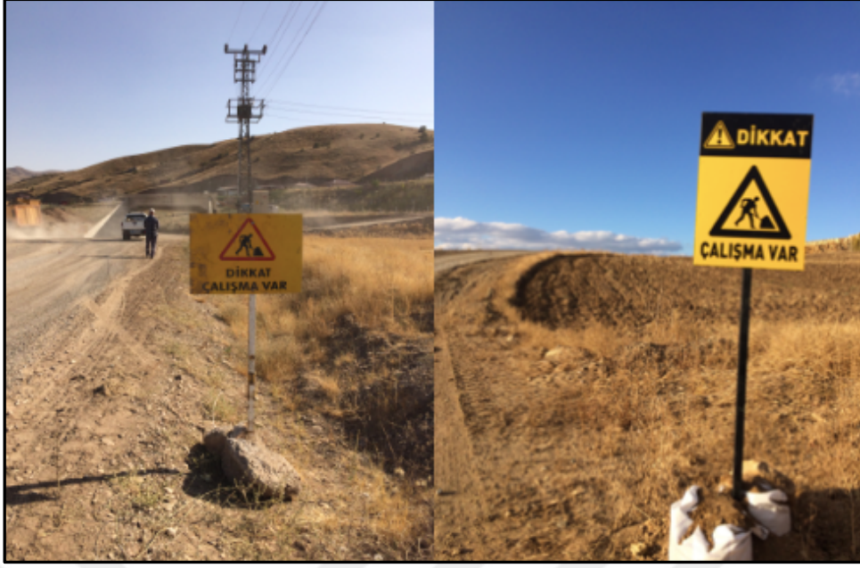
Şekil 5.39 Kazı-Dolgu yapılan sahalara yerleştirilen sarı zemin üzerine siyah piktogramlı “dikkat çalışma var” levhası
