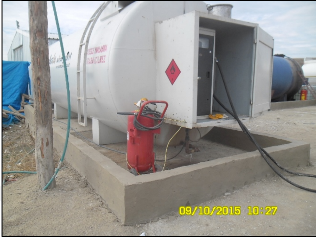
Şekil 5.6 Mazot tankı yangın tüpü ve topraklama bağlantısı
