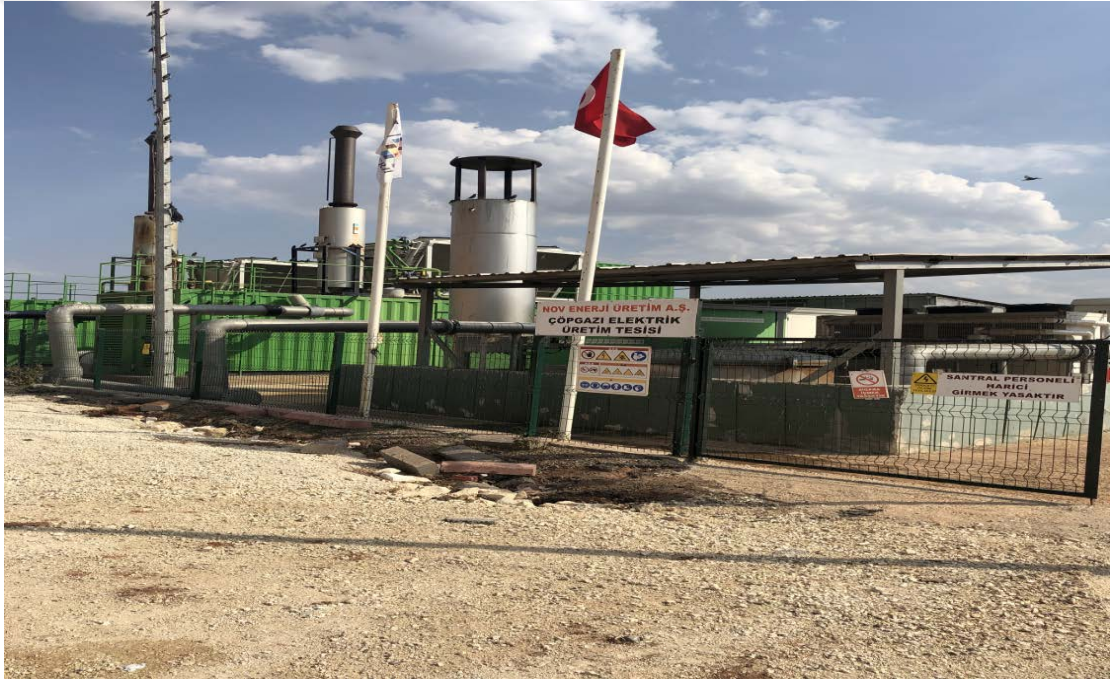
Şekil 5.3 Sivas çöp gazı elektrik üretim tesisi
