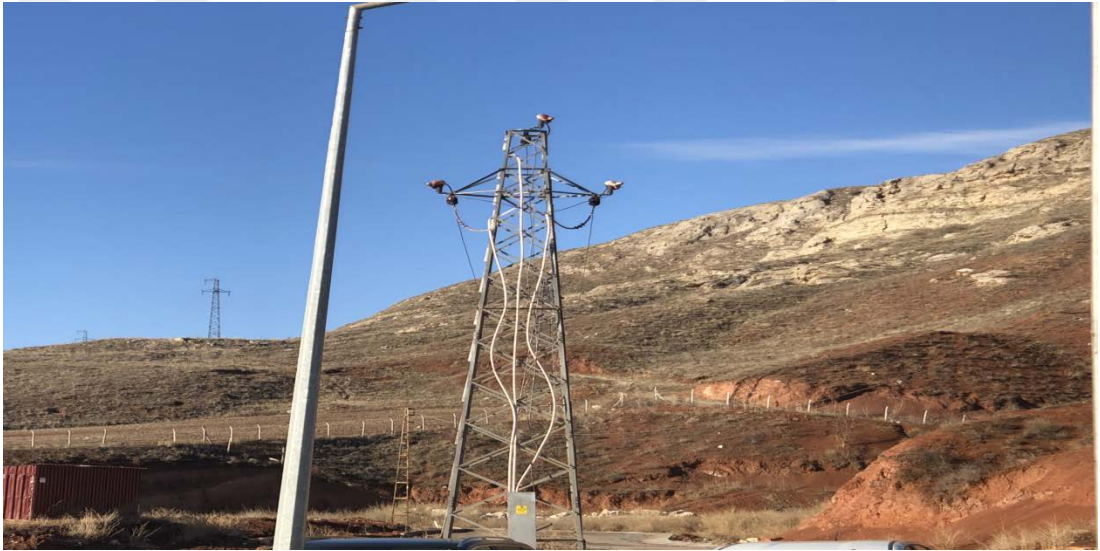
Şekil 5.14 Tesiste üretilen elektriğin enterkonnekte sisteme iletimini yapan direkler
