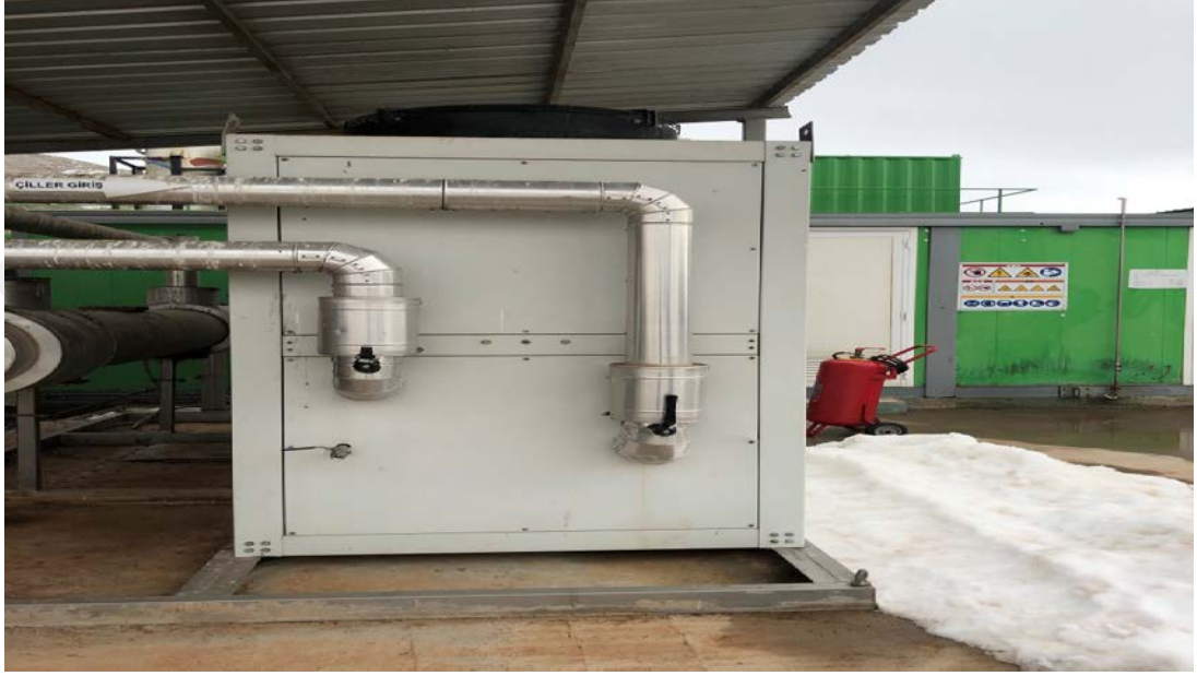
Şekil 5.8 Tesiste gaz soğutma amacıyla kullanılan Chiller sistemi
