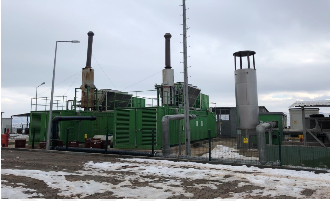
Şekil 5.9 Tesiste kullanılan gaz motorları ve gaz yakma bacası
