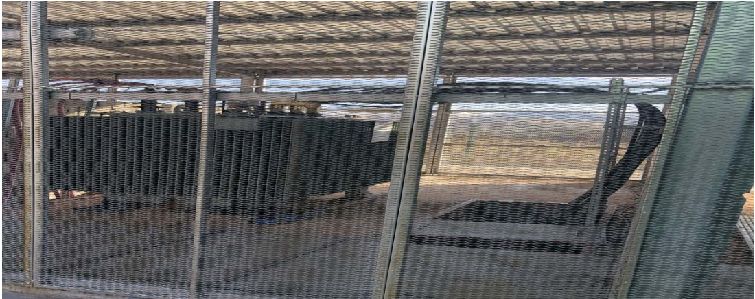
Şekil 5.12 Tesiste kullanılan trafolar
