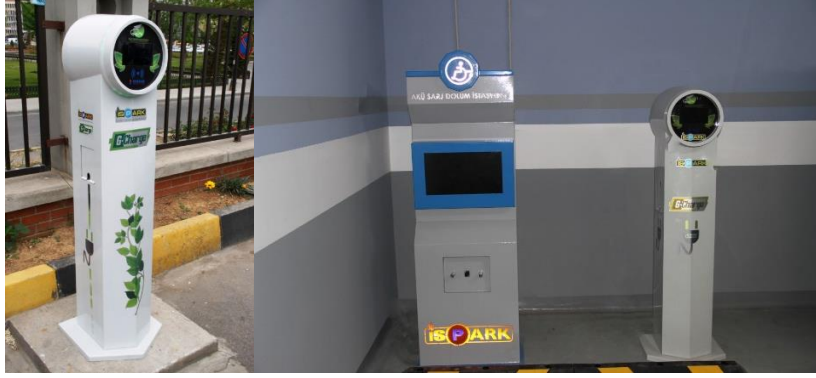
Şekil 2.44. İSPARK elektrikli araç şarj istasyonları [73]
