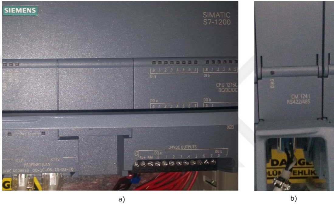
Şekil 3.10. a) Siemens S7-1200 PLC cihazı ve b) CM1241 Modbus Haberleşme Cihazı
