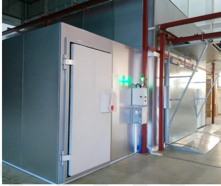
Şekil 2.15. Elektromanyetik olarak korunaklı oda örneği
