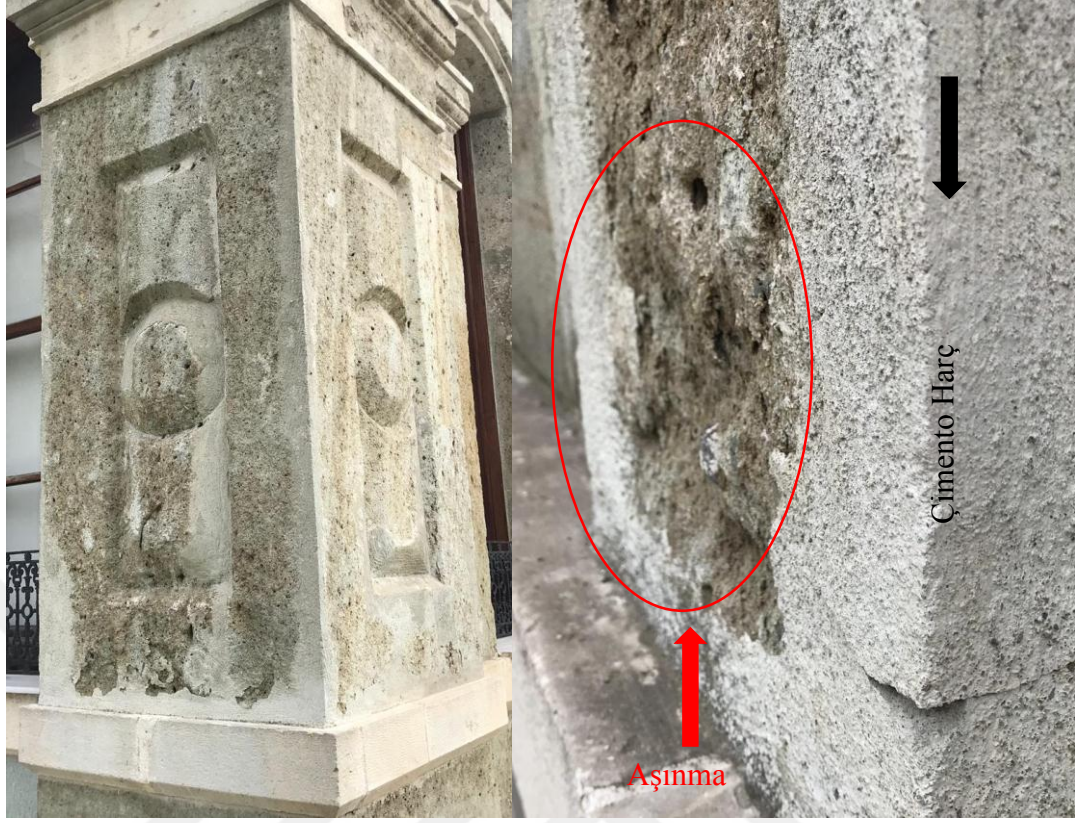
Şekil 2.5. Tamamlayıcı olarak çimento harç kullanılması ve taşın durumu.
