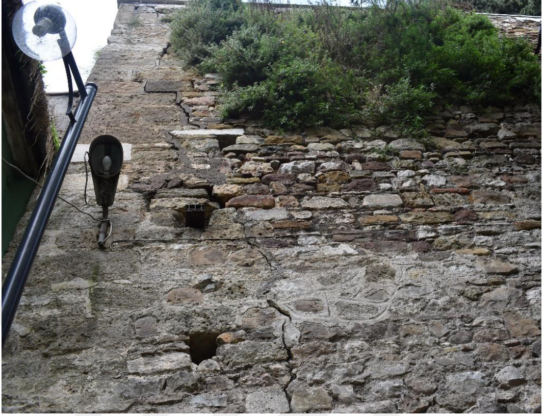
Şekil 2.10. Ek yükler ve depremler sonucu taş yığma istinat duvarında oluşan çatlak.
