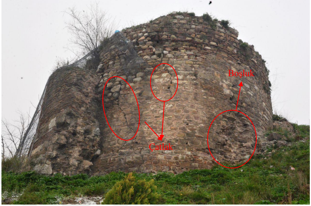
Şekil 2.6. Zemindeki kayma sonucu duvarlarda oluşan çatlak ve boşluklar.
